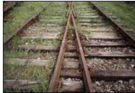
Urmele deraierii vagonului de marfă, vizibile pe traversele din stânga.
