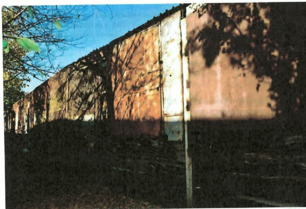
Fig. 16 Sopron (C29): Degradarea materialului lemnos și alcătuirea structurală improvizată
