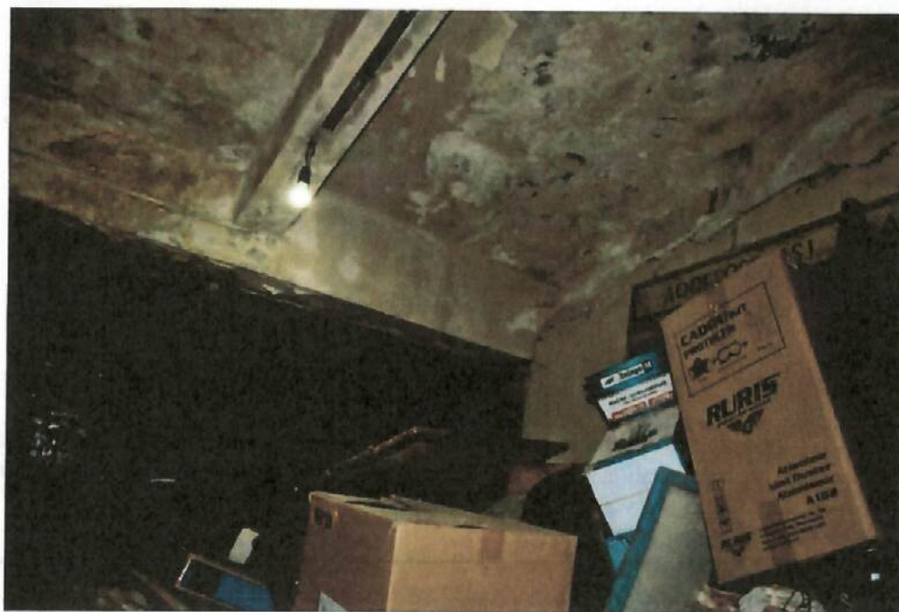
Fig. 14 Atelier intretinere 11, Atelier turnatorie (C28): Mucegai și igrasie la nivelul planșeului din beton armat
