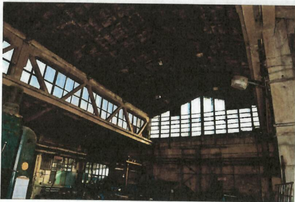
Fig. 2 C28- Atelier intretinere 11,Atelier turnatorie (C28): Luminator central și chesoane din beton armat
