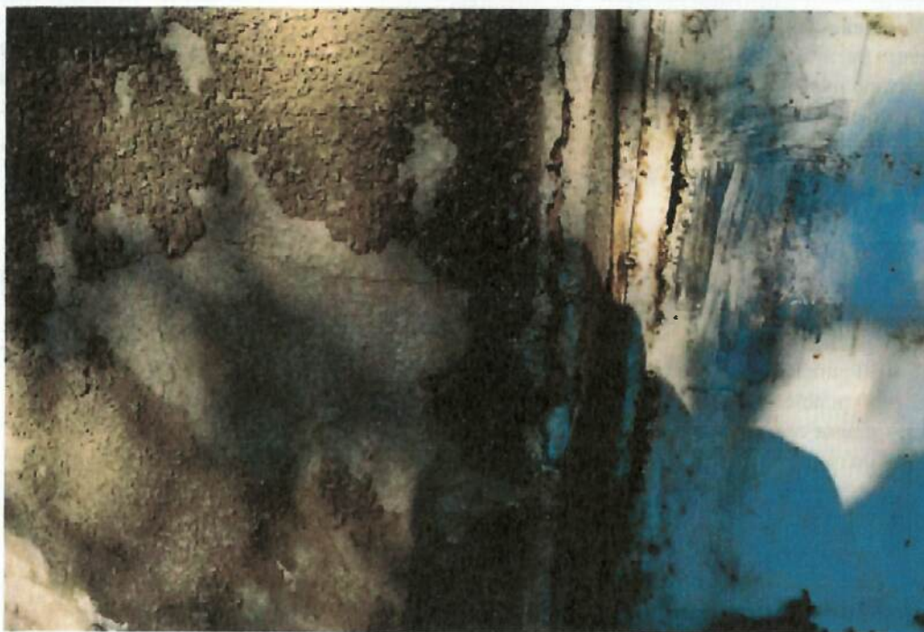
Fig. 22 Garaj (C34): Degradări ale fațadei exterioare
