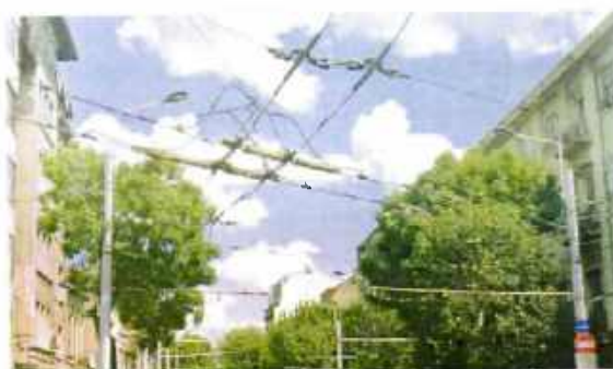
(b) Încrucișare deteriorată – M. Kogălniceanu
