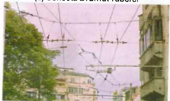
(f) Traversă, consolă și macaz Str. Occidentului
