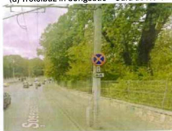
(c) Stâlp deteriorat – Șos. Cotroceni
