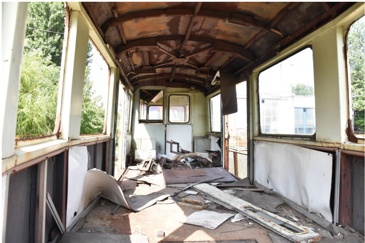
S21 – interiorul, prezent în condiții de degradare profundă.
