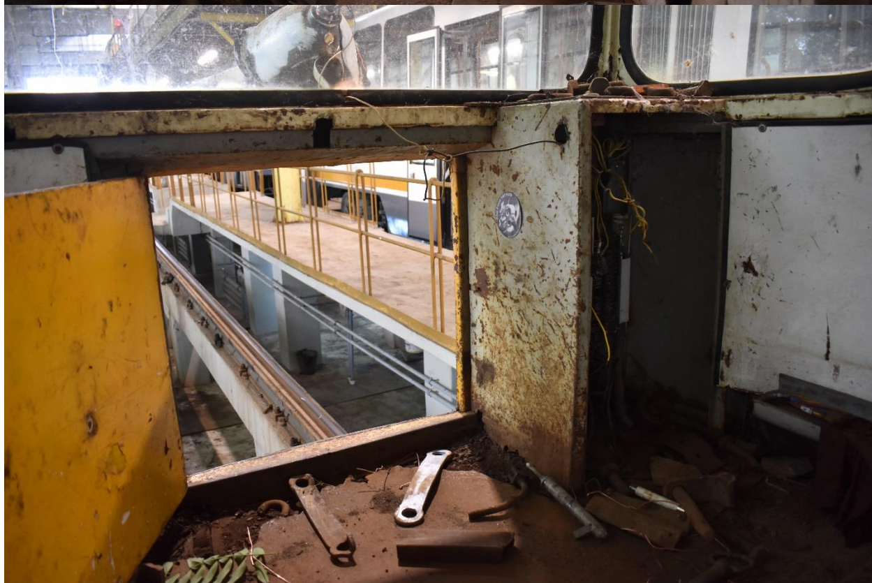
6069 – interiorul, în condiție accentuată de degradare.
