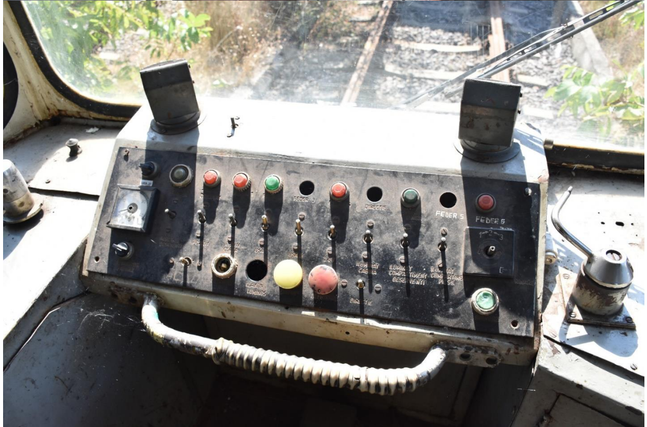
6047 – postul de conducere, degradat, modificat masiv față de configurația originală.
