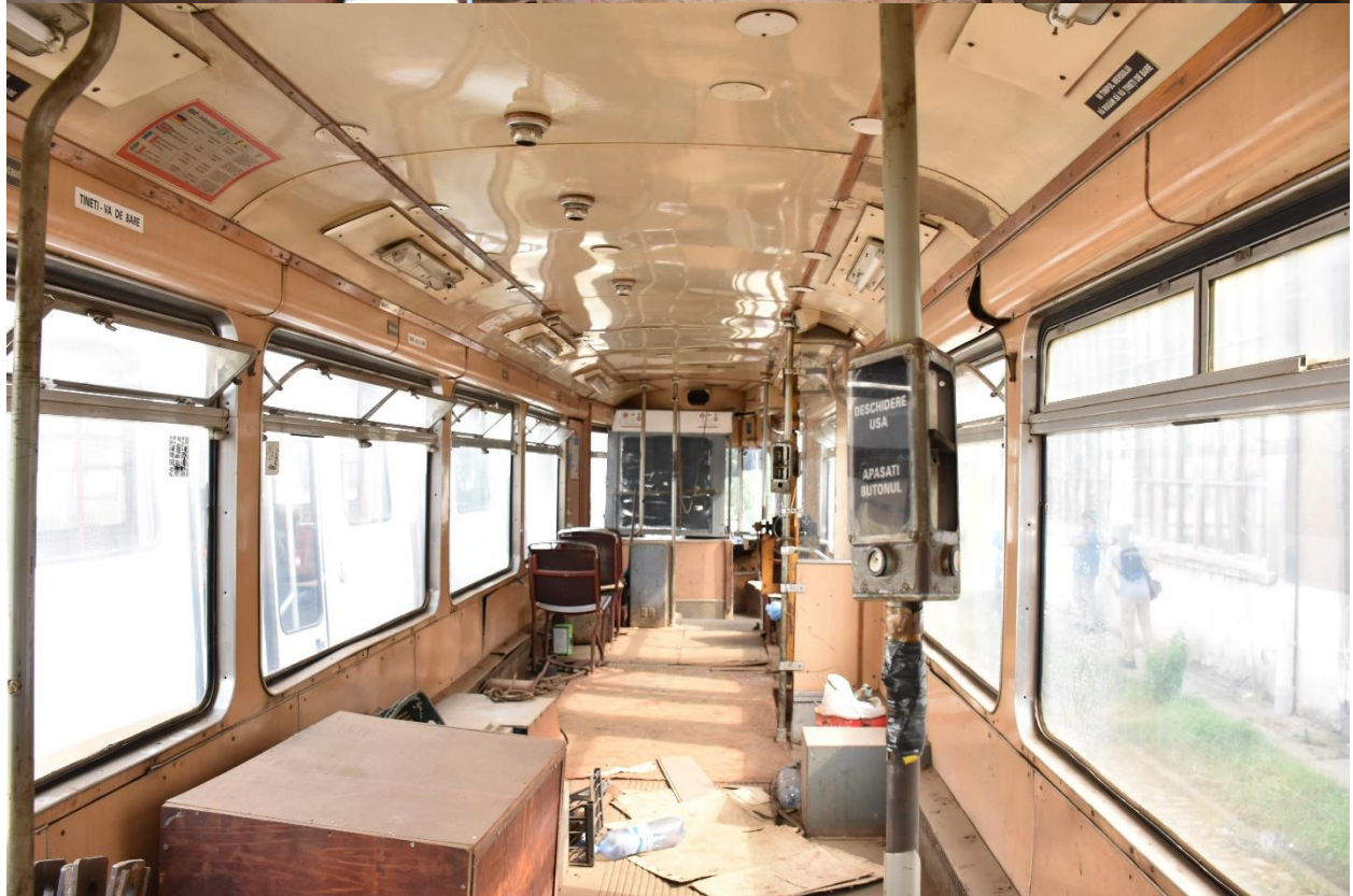
2525 – interiorul, în condiții de degradare, modificat în scop utilitar. Majoritatea componentelor originale au fost eliminate.
