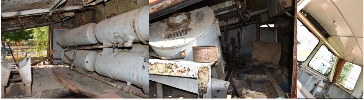
Turbofreza 03 – interiorul, în stare de degradare , iar o parte din componente lipsesc.
