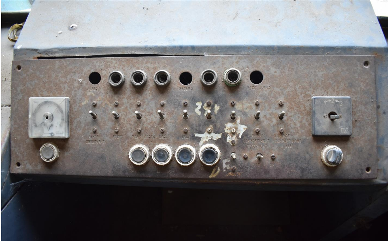
6089 – postul de conducere, în condiții precare, cu componente lipsă sau afectate de coroziune.
