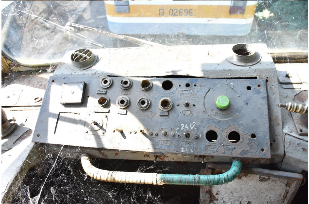
6050 – postul de conducere, profund degradat.
