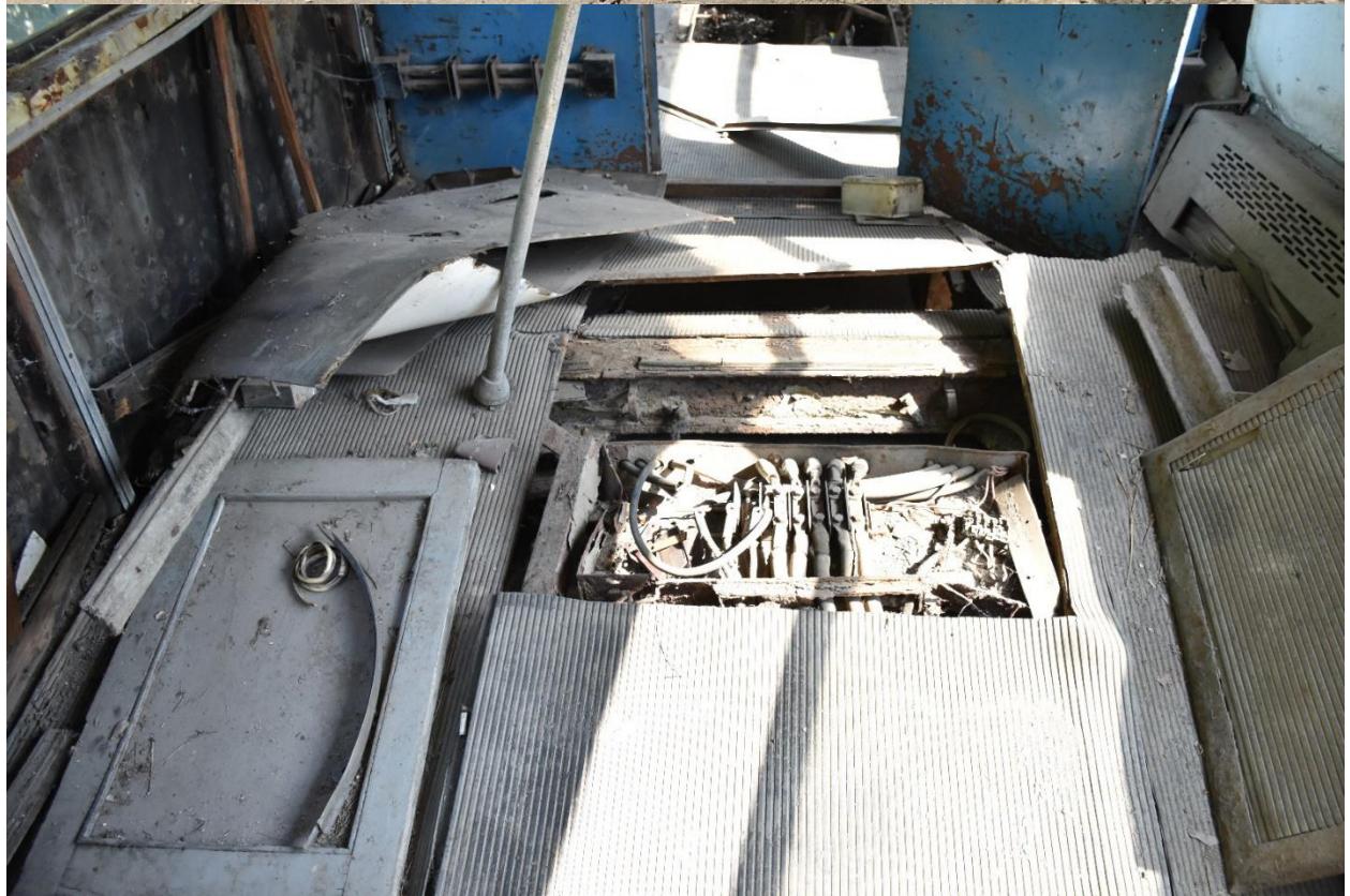
6050 – boghiul 1 a penetrat podeaua tramvaiului.
