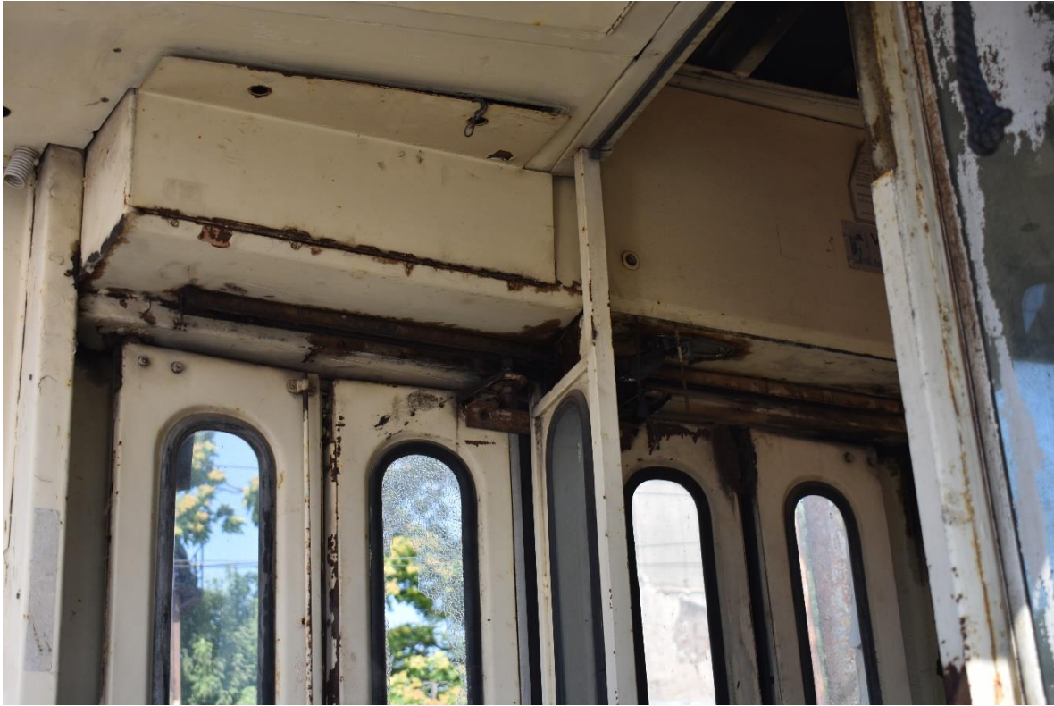
4042 – interior, detaliu mecanism ușa 1. Elemente corodate în principal datorită sustragerii geamurilor, însă nu se remarcă elemente lipsă.
