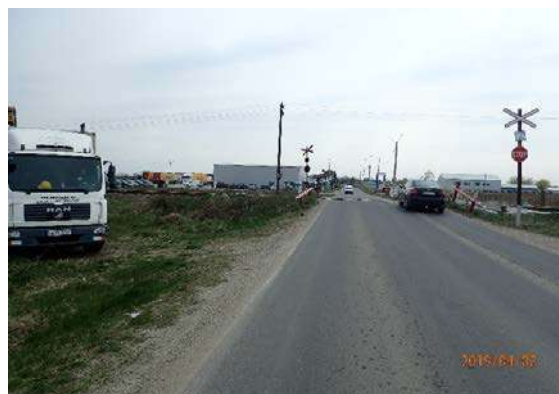
Vedere spre satul Dimieni (trecerea la nivel care se înlocuiește cu pasaj inferior)
