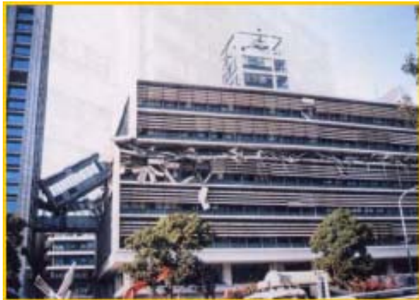
Fig. 1.13 Kobe City Hall afectat de cutremur.
