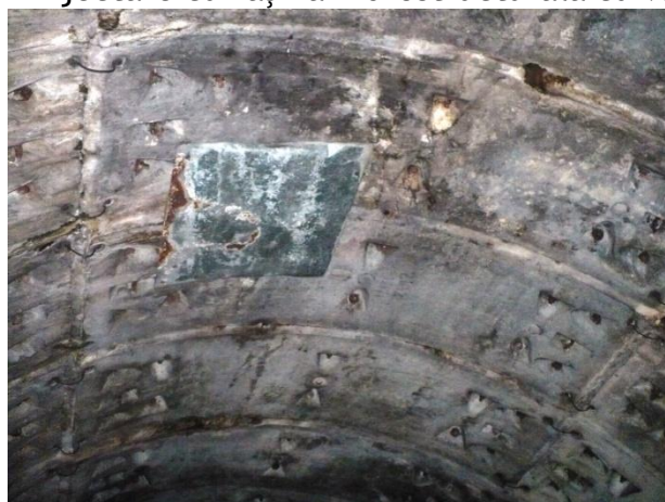
Similar, la inelul 815. Se etanșează prin injectare cu rășină hidrostructurală cu vâscozitate redusă
