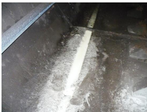
Infiltrație prin fundația căii de rulare, în zona inelelor 690÷685. Este necesară demolarea fundației de cale (6m), etanșarea prin injectare cu rășină hidrostructurală cu vâscozitate redusă, urmat de refacerea acesteia
