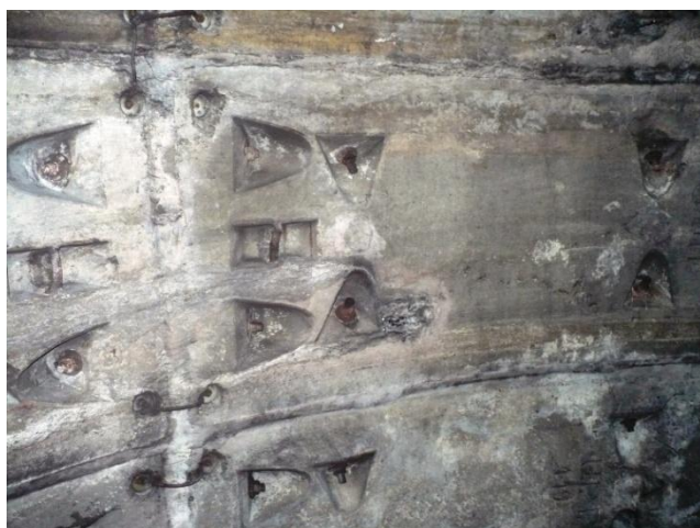
Infiltrație prin bolta tunelului, la inel 671. Se etanșează prin injectare cu rășină poliuretanică
