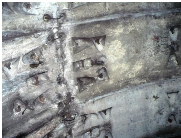
Infiltrație prin bolta tunelului, la inel 630. Se etanșează prin injectare cu rășină poliuretanică
