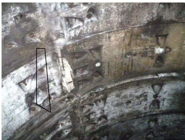
Infiltrație în boltă, la inelul 340
