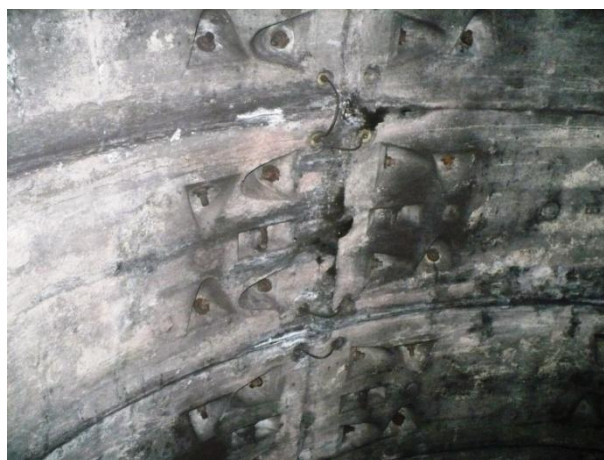
Infiltrație prin rost longitudinal între bolțari, la inel 190. Se etanșează prin injectare cu rășină hidrostructurală cu vâscozitate redusă
