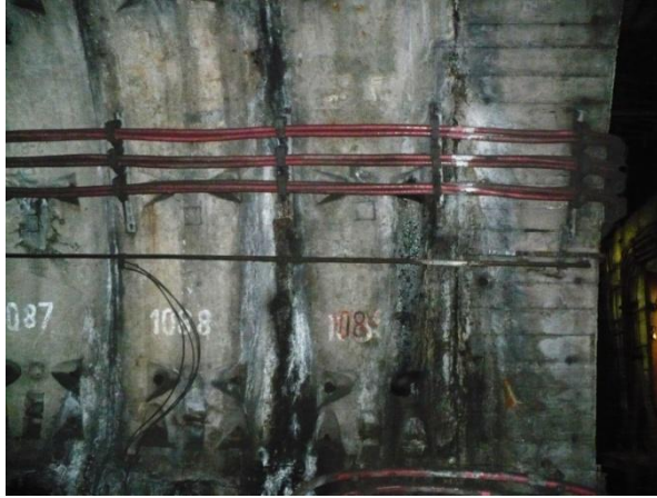
Infiltrații între peretele de fronton al stației și tunel (inel 1089), inclusiv la rostul transversal al inelului următor (inel 1088). Se etanșează cu rășină hidrostructurală cu vâscozitate redusă
