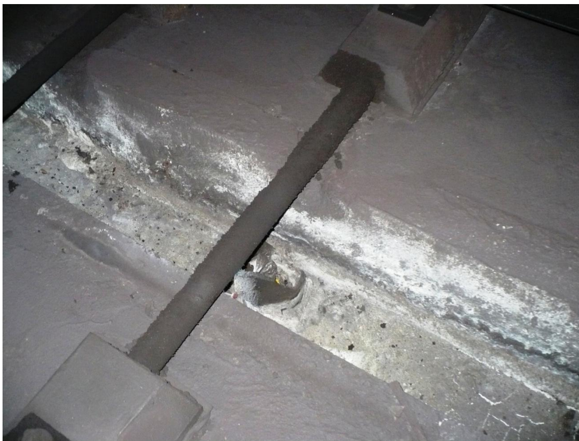
Țeava PVC Dn 150mm, din dren, este obturată (este colmatată, nefiind funcțională)
