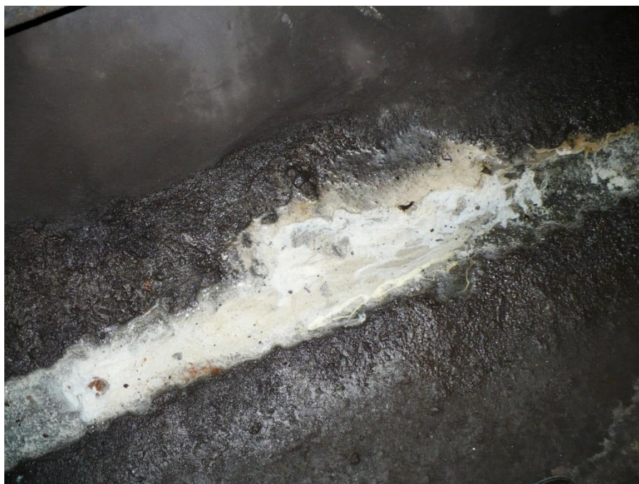
Infiltrație prin fundația căii de rulare, în zona inelului 370. Este necesară demolarea fundației de cale (4m), etanșarea prin injectare cu rășină hidrostructurală cu vâscozitate redusă, urmat de refacerea acesteia
