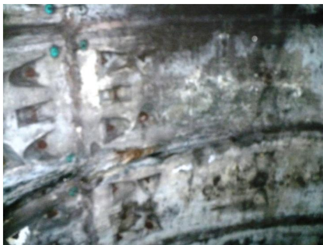
Infiltrații prin rost transversal între bolțari, în boltă, la inelul 255. Se etanșează cu rășină hidrostructurală cu vâscozitate redusă
