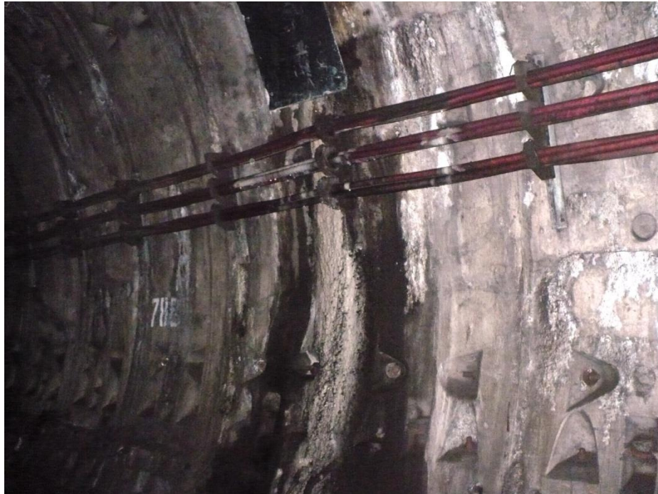
Infiltrații prin rosturile din bolta tunelului, în dreptul inelului 786; Se vor opri prin etanșare cu rășină hidrostructurală acrilică, cu vâscozitate redusă
