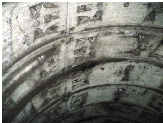
Infiltrații prin rost transversal, în boltă, la inel 675. Se etanșează cu rășină hidrostructurală cu vâscozitate redusă
