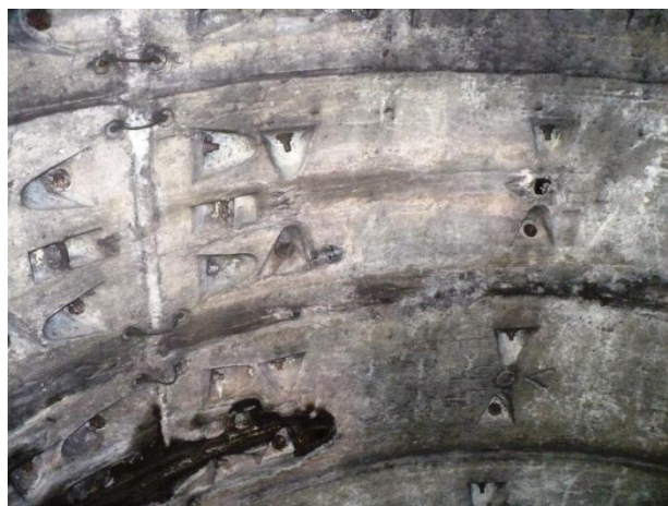
Infiltrație prin gaură bulon, în bolta tunelului, la inel 502. Se etanșează prin injectare cu rășină poliuretanică
