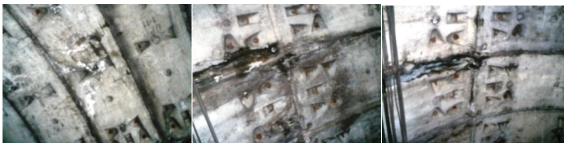
Infiltrații prin rost transversal în bolta inelelor 305, 360, 395. Se etanșează cu rășină hidrostructurală cu vâscozitate redusă
