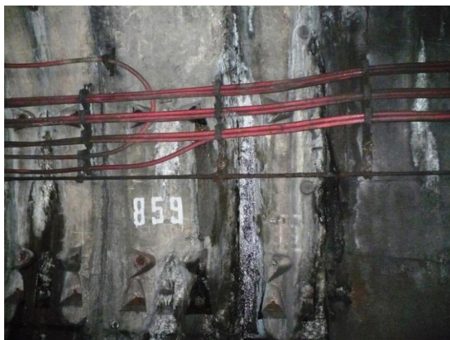
Infiltrații prin rosturile dintre bolțari, la inelele 858÷861. Se etanșează prin injectare cu rășină hidrostructurală cu vâscozitate redusă
