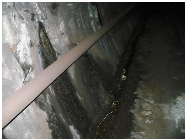
Infiltrații prin rosturi transversale între bolțari, lateral, la inelul 210. Se etanșează cu rășină hidrostructurală cu vâscozitate redusă
