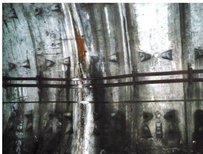
Infiltrații prin rost transversal cu aport de nisip, lateral, la inel 514. Se etanșează cu rășină hidrostructurală cu vâscozitate redusă
