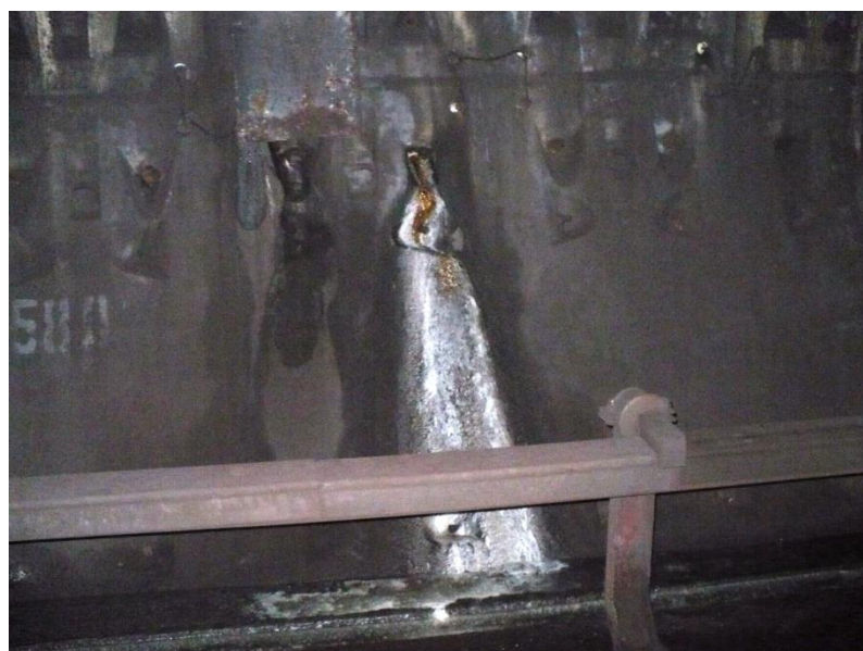
Similar, la inelul 579, infiltrație prin găurile buloanelor. Este necesară etanșarea prin injectare cu rășină poliuretanică
