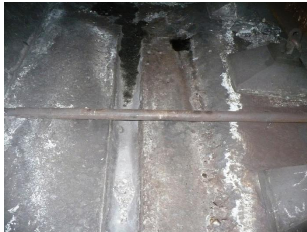
Țeavă de trecere a instalației electrice către calea de rulare, montată la circa 5 cm față de cota banchetei de circulație. Este necesară montarea acesteia, la cota banchetei
