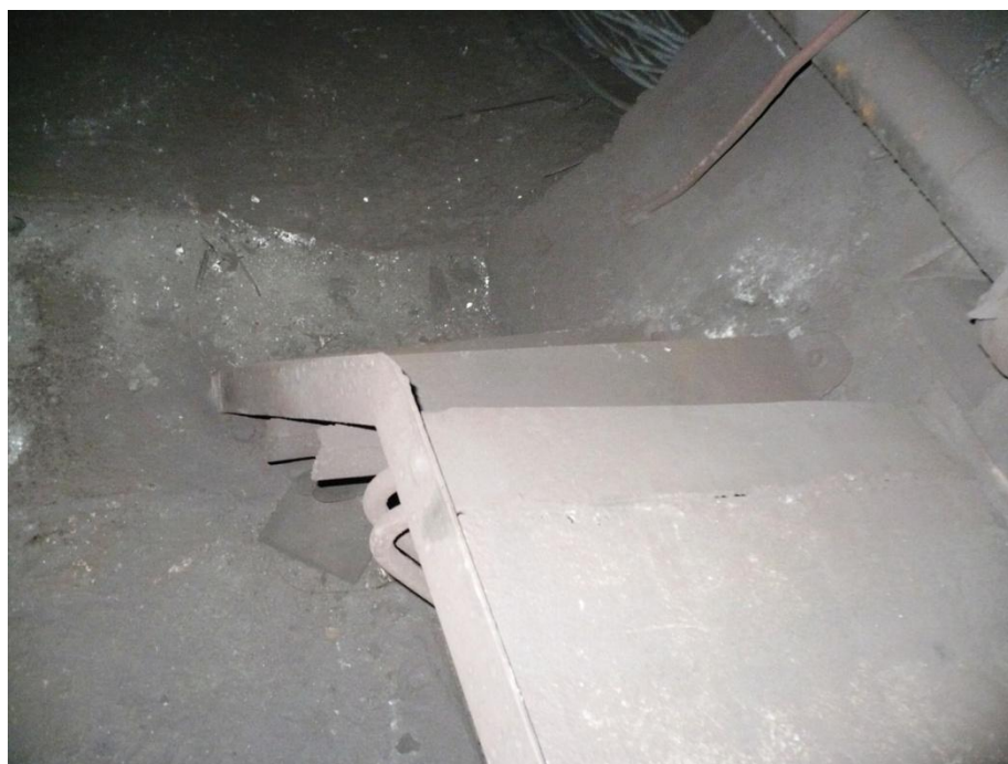
Zonă cu banchetă de circulație, între inelele 1÷135 (135m). Se va demonta și se va executa și monta o banchetă nouă
