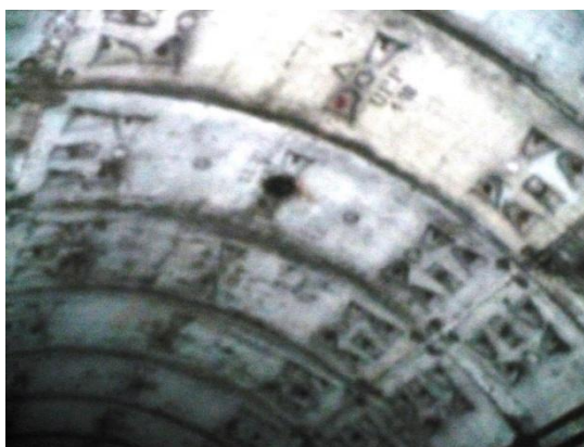
Infiltrație prin gaură injectare primară, la inel 1555, în boltă. Se etanșează cu rășină poliuretanică
