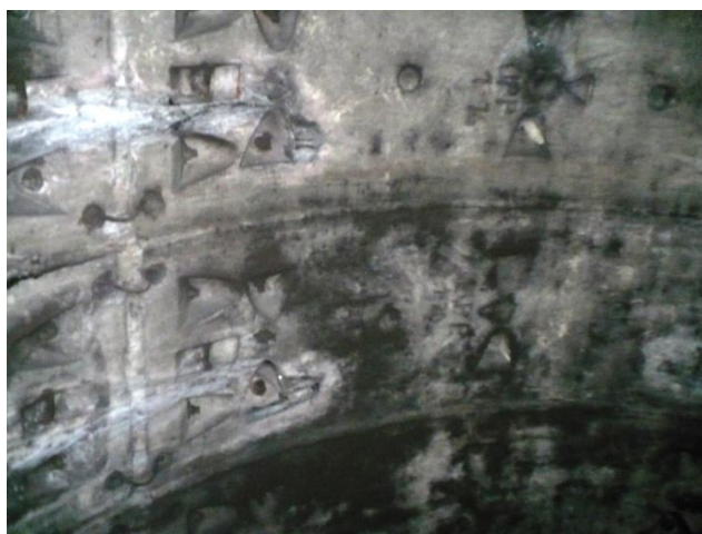
Infiltrație în bolta tunelului, la inel 45. Se etanșează prin injectare cu rășină poliuretanică
