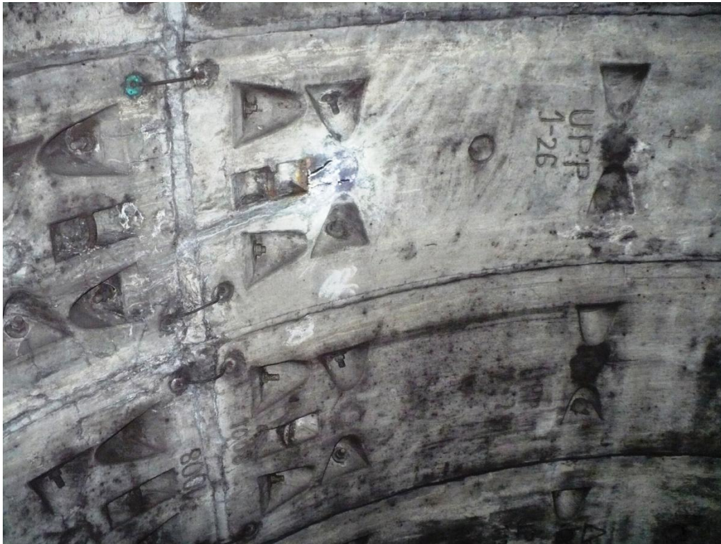
Infiltrație în rostul dintre bolțari, în boltă, la inelul 965
