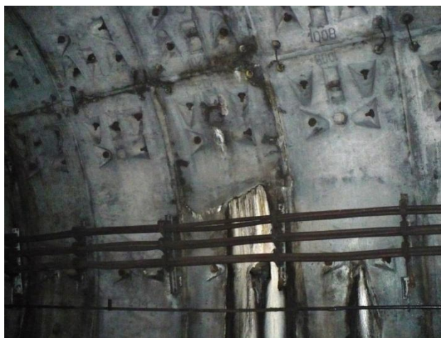
Infiltrație prin fisură în bolțar lateral, la inel 425. Se etanșează prin injectare cu rășină hidrostructurală cu vâscozitate redusă
