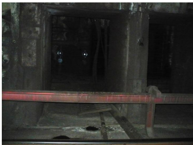
Infiltrații din boltă, în zona prizei de ventilație. Se etanșează cu rășină poliuretanică
