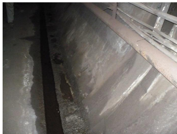
Infiltrații din vatră, între inelele 25÷32.
