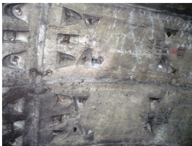
Infiltrație în bolta tunelului, la inel 555. Se etanșează prin injectare cu rășină poliuretanică
