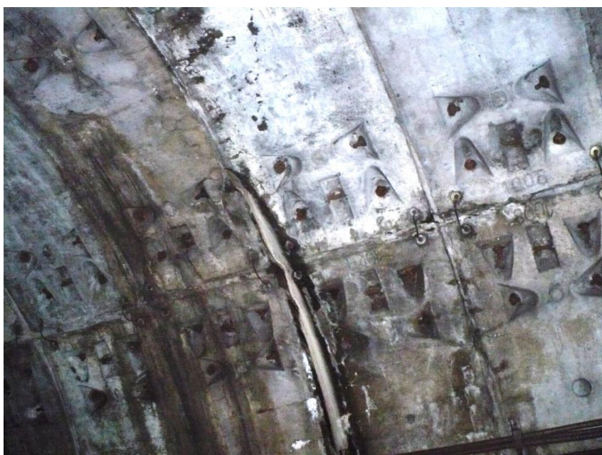
Infiltrații prin rostul transversal al bolțarilor de la inelele 420 și 419. Este necesară etanșarea prin injectare cu rășină hidrostructurală cu vâscozitate redusă
