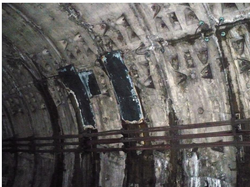
Zonă cu infiltrații în dreptul inelului 845, la nivelul bolțarilor din boltă, acoperită cu tablă, pentru a împiedica ajungerea apei în zona de circulație a ramelor de metrou
