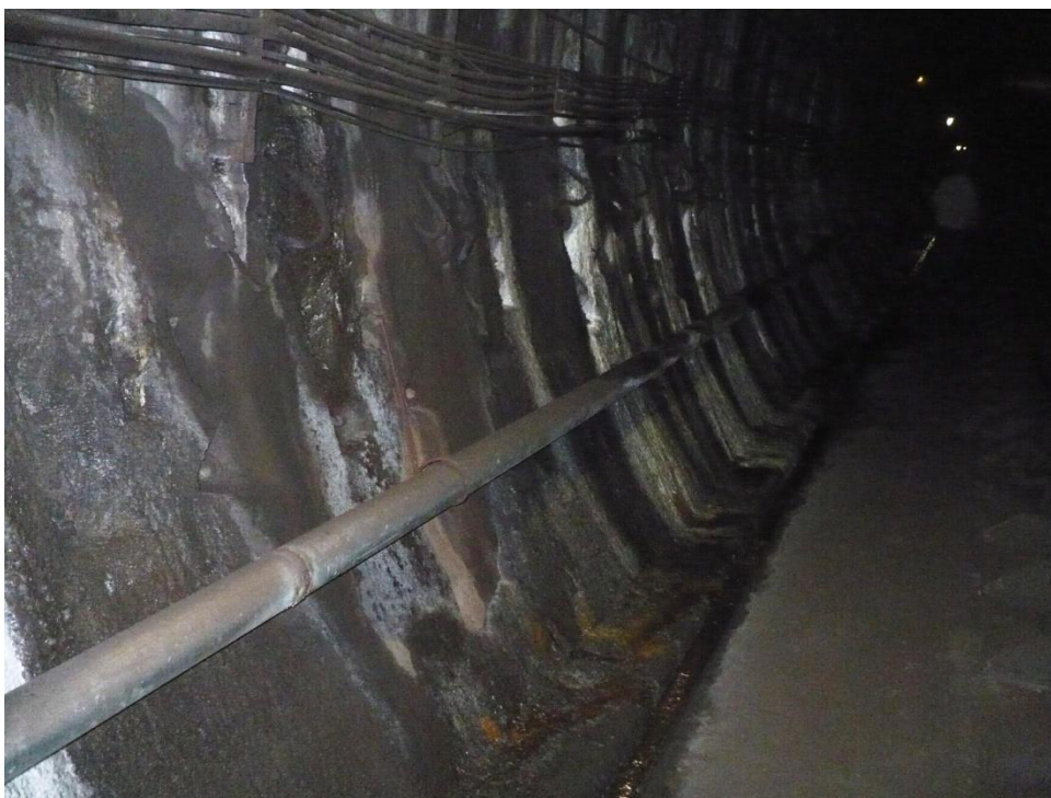
Infiltrații între inelele 715÷745 (partea stângă), deasupra fundației de cale; Infiltrațiile trebuiesc oprite, acestea ajungând în zona căii de rulare, ca urmare a presiunii existente în lungul fisurilor din bolțari
