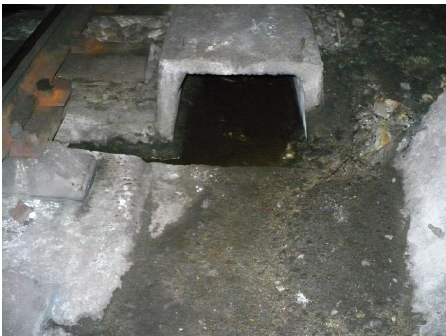
Zona de racord cu PLS Bibescu Vodă are montată necorespunzător rigola prefabricată pentru dirijarea apelor de infiltrație; se distinge circulația apelor în afara rigolei
