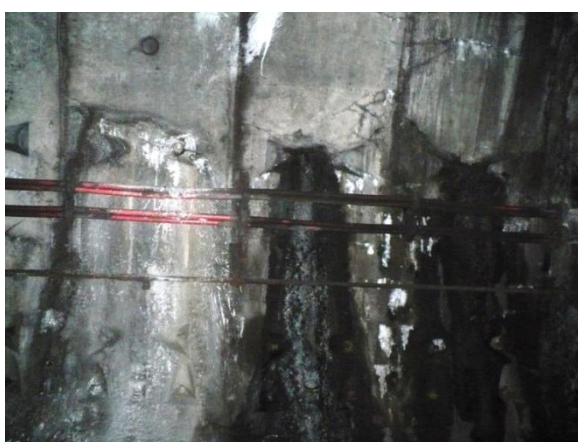
Infiltrații prin găuri de injectare primară, la bolțari laterali, în zona inelului 80. Se etanșează cu rășină poliuretanică
