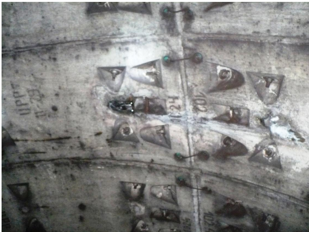
Infiltrație prin gaură injectie primară, în bolta inelului 280
