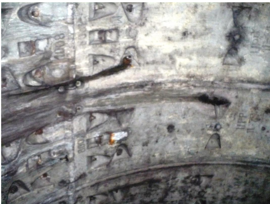
Infiltrație prin gaură de injecție primară, în bolta inelului 1045
