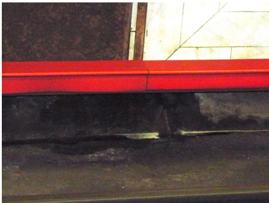
Deversare apă menajeră, prin spatele peretelui cortină, în rigola căii de rulare, pe firul 2 de circulație
