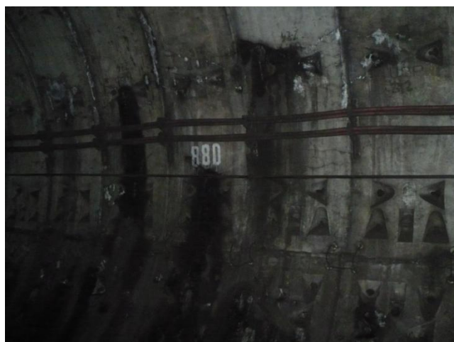
Infiltrații prin găuri bulon, în zona inelului 880. Se etanșează cu rășină poliuretanică
