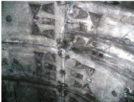
Infiltrații, în boltă, la inelul 15
