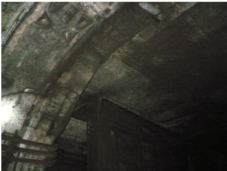
Infiltrații prin bolta inelului de legătură cu zona de detentă a stației C-tin Brâncoveanu
