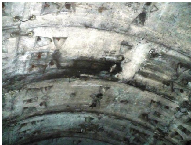
Infiltrații prin gaura de injectare primară a bolțarului din boltă, la inelul 550. Se etanșează cu rășină poliuretanică
