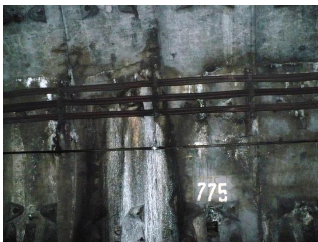
Infiltrații prin fisurile bolțurilor laterali de la inelele 777÷773. Se etanșează prin injectare cu rășină poliuretanică
