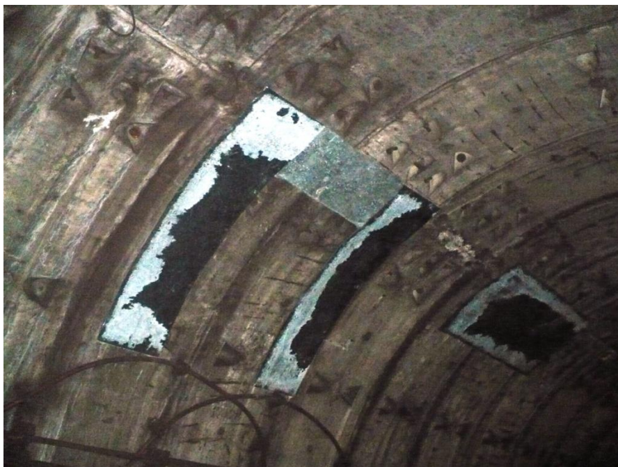
Infiltrații în zona bolții tunelului, pe porțiunea inelelor 15÷11, acoperite cu tablă
