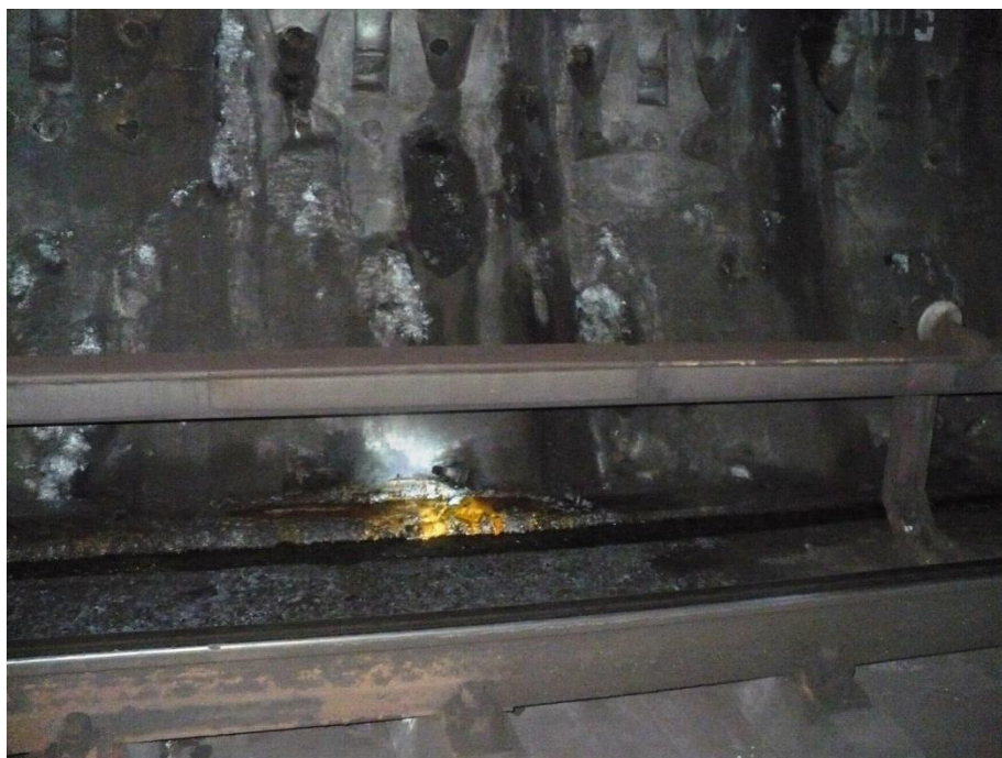
Infiltrație cu aport de nisip, la inelul 605, deasupra fundației de cale Este necesară demolarea fundației de cale (3m), etanșarea prin injectare cu rășină hidrostructurală cu vâscozitate redusă, urmat de refacerea acesteia
