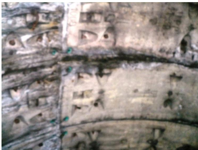
Infiltrații la rost transversal între bolțari, în boltă, la inel 155. Se etanșează cu rășină hidrostructurală cu vâscozitate redusă
