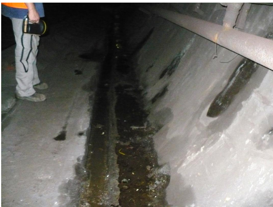
Infiltrații, la limita fundației de cale, în zona inelelor 485÷230 Este necesară demolarea fundației de cale (256m), etanșarea prin injectare cu rășină hidrostructurală cu vâscozitate redusă, urmat de refacerea acesteia
