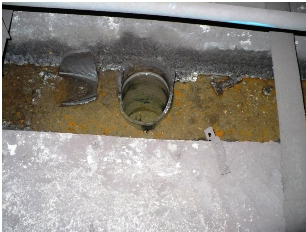
Teavă de drenaj, din ampriza rigolei centrale, colmatată, la inelul 875
