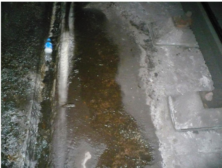
Infiltrație prin fundația căii de rulare, în zona inelului 425. Este necesară demolarea fundației de cale (3m), etanșarea prin injectare cu rășină hidrostructurală cu vâscozitate redusă, urmat de refacerea acesteia
