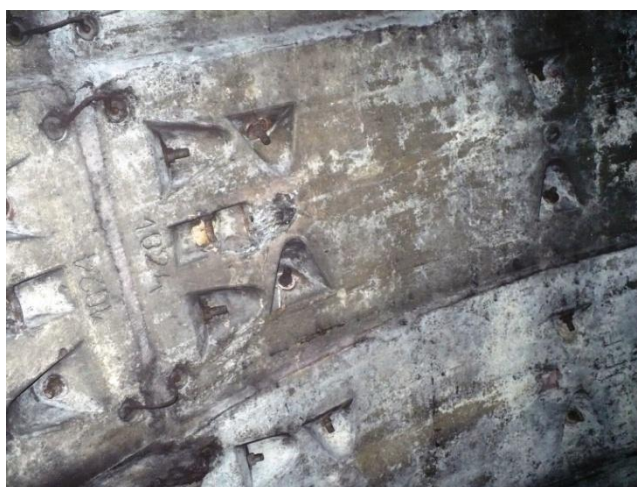
Infiltrație prin bolta tunelului, la inel 690. Se etanșează prin injectare cu rășină poliuretanică
