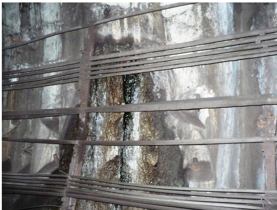
Infiltrație, la rostul dintre bolțari și prin fisuri, în zona inelului 485
