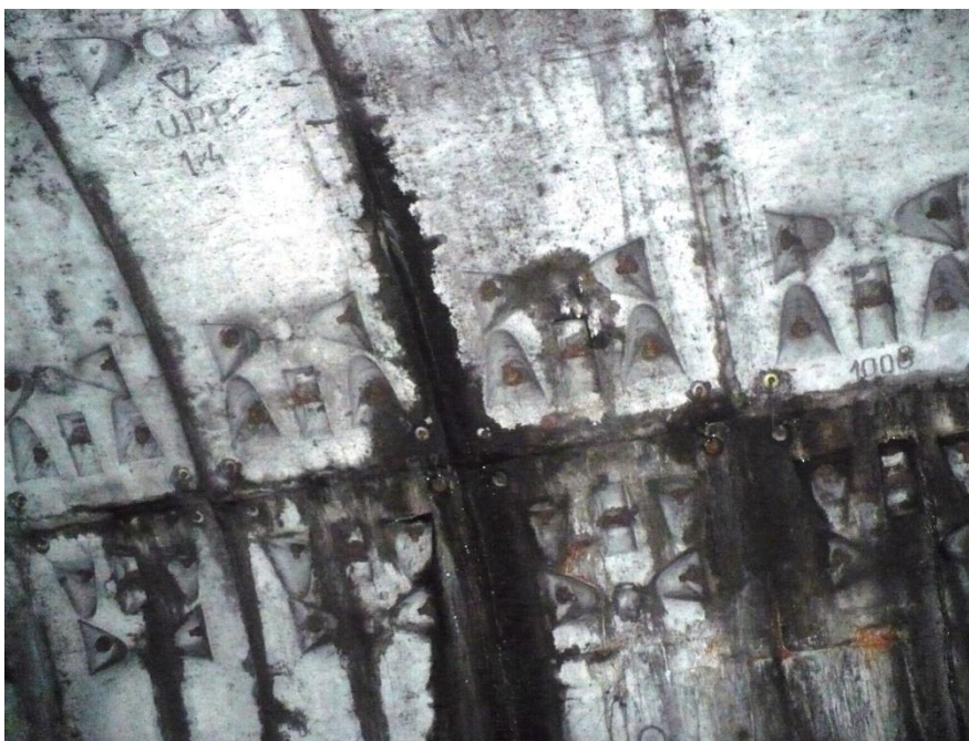
Infiltrații în zona bolții, la inelul 265, prin rost transversal între bolțari. Se etanșează cu rășină hidrostructurală cu vâscozitate redusă
