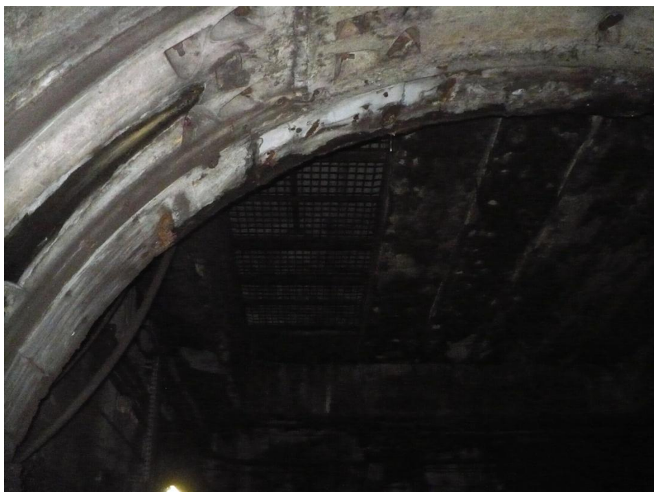
Infiltrații prin peretele de fronton de la legătura cu stația Piața Victoriei 1. Se etanșează cu rășină hidrostructurală cu vâscozitate redusă
