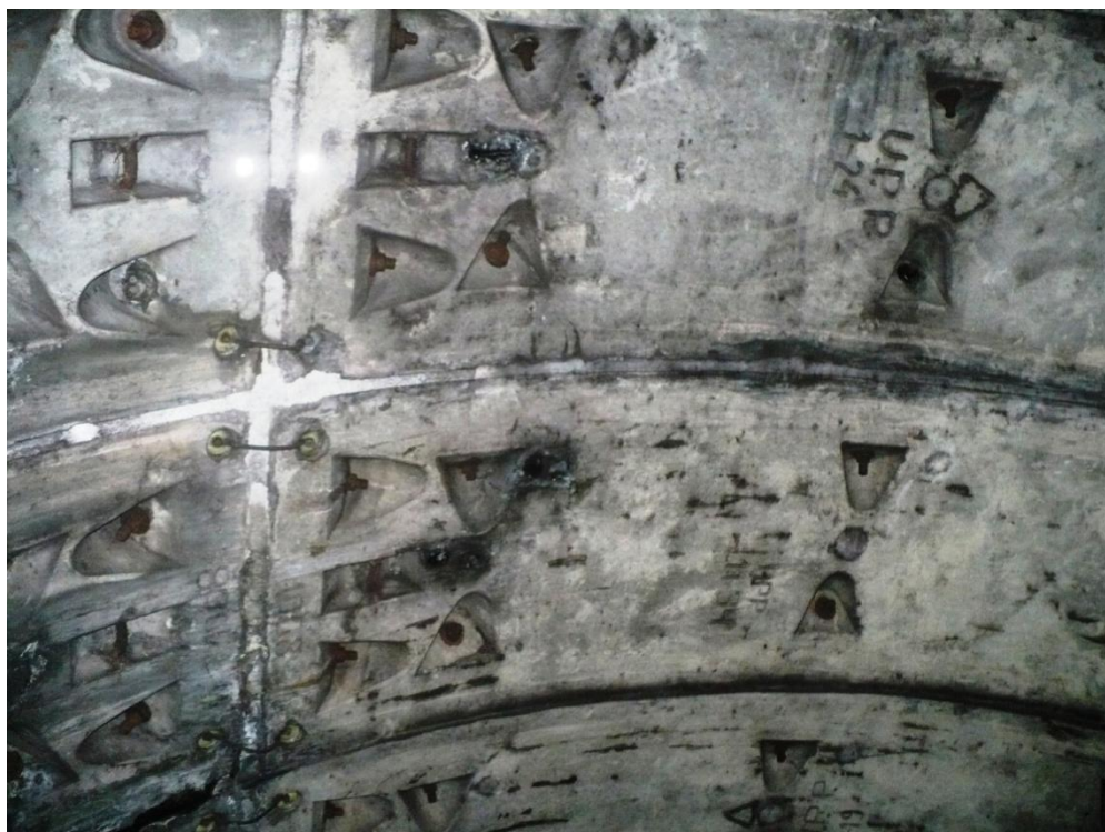
Infiltrații prin rosturi tansversale, în bolta inelului 945. Se etanșează cu rășină hidrostructurală cu vâscozitate redusă
