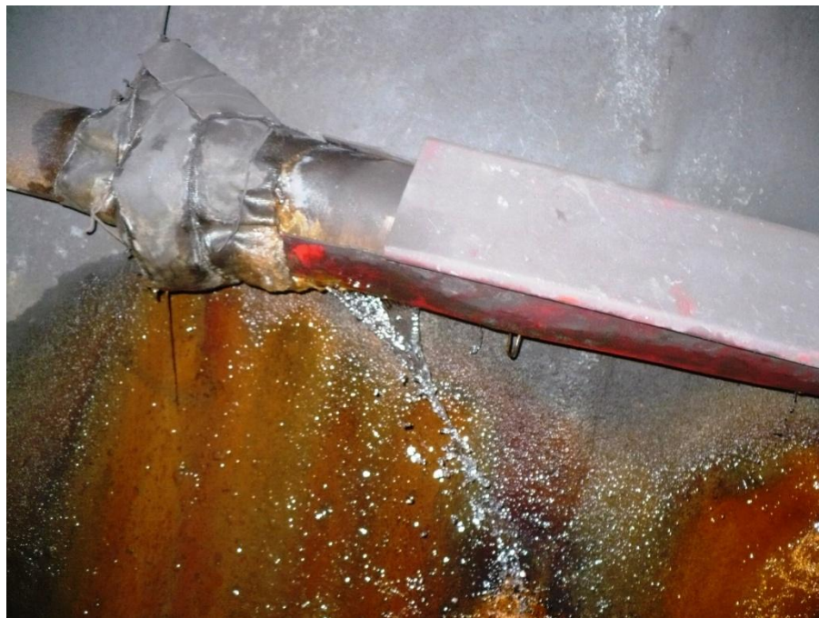
Țeavă de incendiu fisurată, manșonată cu tablă, pentru protejarea zonei căii de rulare, la inelul 1115
