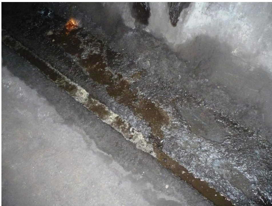
Infiltrații în zona inelului 1181, partea stângă; Se va demola fundația de cale pe circa 1,0 m de o parte și de alta a punctului de infiltrație. După etanșare, se va rebetona fundația de cale cu beton C30/37 (aprox.3m)
