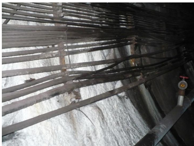
Infiltrații prin rosturile dintre bolțari, cu aport de material solid, la inelul 375. Se etanșează prin injectare cu rășină hidrostructurală cu vâscozitate redusă
