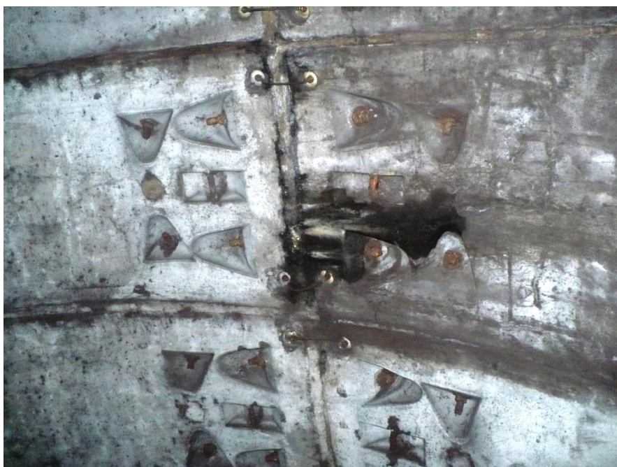
Infiltrații în zona bolții, la inelul 230, prin rost longitudinal între bolțari. Se etanșează cu rășină hidrostructurală cu vâscozitate redusă
