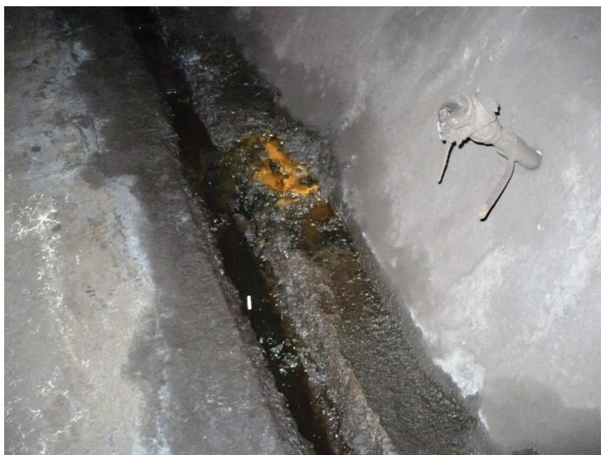
Infiltrație cu aport de nisip, la inelul 600, deasupra fundației de cale Zona, deși injectată, nu a fost etanșată. Este necesară demolarea fundației de cale (3m), etanșarea prin injectare cu rășină hidrostructurală cu vâscozitate redusă, urmat de refacerea acesteia
