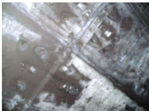
Infiltrație prin gaură bulon, în boltă, la inelul 1122. Se etanșează zona cu rășină poliuretanică
