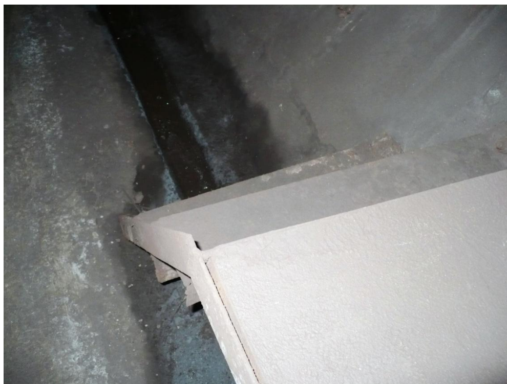
Banchetă metalică de circulație între inelele 880 și 950 (capăt tunel) (70m)
