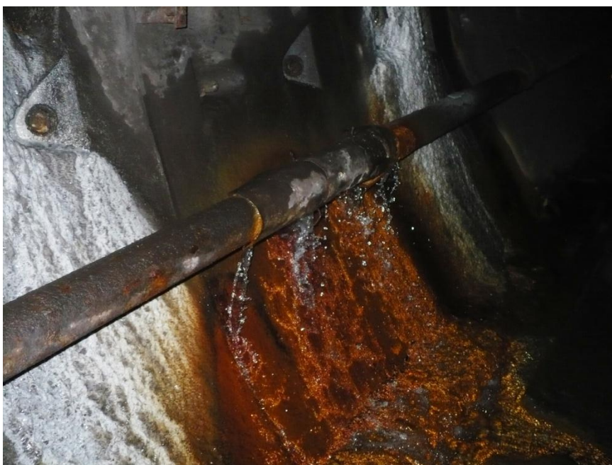
Țeavă de incendiu fisurată, manșonată cu o membrană cauciucată, pentru protejarea zonei căii de rulare, la inelul 410
