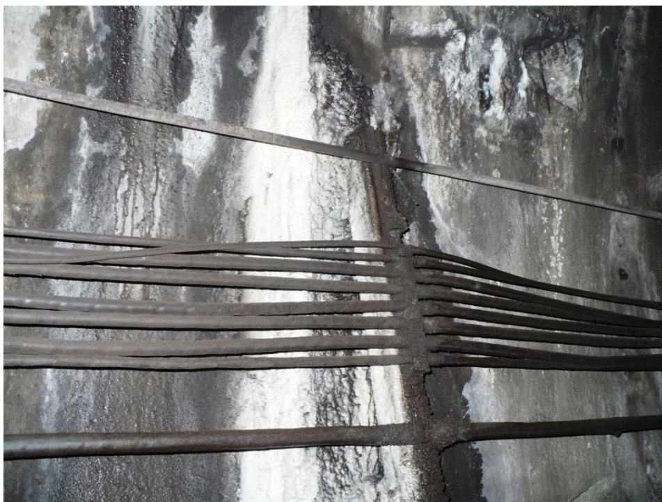
Infiltrații prin rosturile transversale și longitudinale, la inelul 93; Infiltrațiile trebuiesc oprite, acestea ajungând în zona căii de rulare, ca urmare a presiunii existente în lungul fisurilor din bolțari
