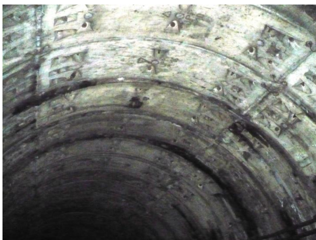
Infiltrații prin rost transversal, în boltă, la inel 860. Se etanșează cu rășină hidrostructurală cu vâscozitate redusă
