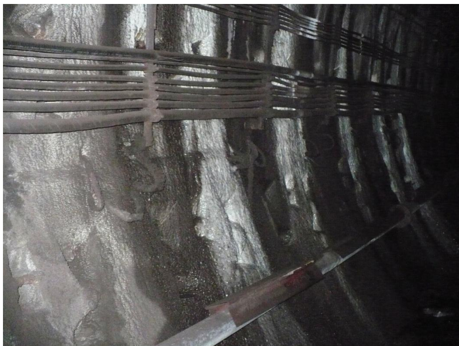
Infiltrații prin rosturile bolțarilor de la inelele 685÷695; Infiltrațiile trebuiesc oprite, acestea ajungând în zona căii de rulare, ca urmare a presiunii existente în lungul fisurilor din bolțari
