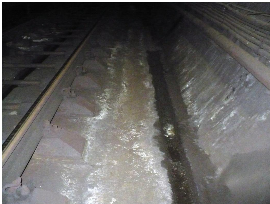
Infiltrații la rostul dintre fundația de cale și tunel, de la inelul 1135, pe circa 10m lungime. Este necesară demolarea fundației de cale (10m), etanșarea prin injectare cu rășină hidrostructurală cu vâscozitate redusă, urmat de refacerea acesteia
