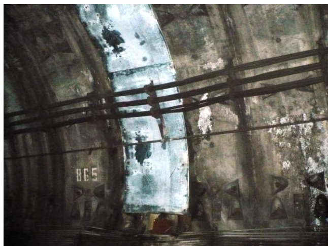
Infiltrații prin rosturi și fisuri, la inelul 865, acoperite cu tablă. Se etanșează prin injectare cu rășină hidrostructurală cu vâscozitate redusă
