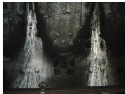
Infiltrații prin rosturi transversale, cu aport de material solid, lateral, la inel 1759. Se etanșează cu rășină hidrostructurală cu vâscozitate redusă
