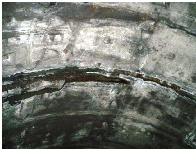
Infiltrație prin rost transversal între bolțari, la inel 60. Se etanșează prin injectare cu rășină hidrostructurală cu vâscozitate redusă
