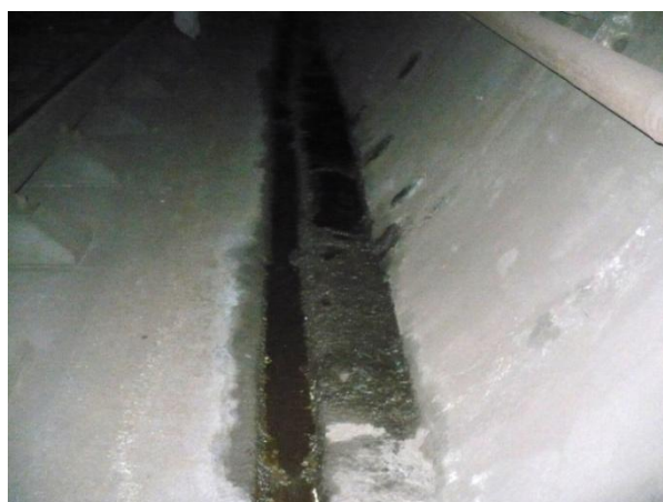
Infiltrații din fundația de cale, între inelele 440÷445.
