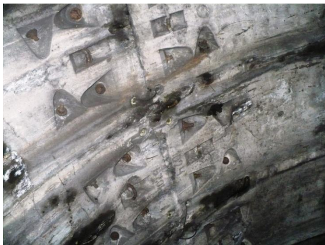
Infiltrații prin gaură bulon, în bolta tunelului, la inel 895. Se etanșează cu rășină poliuretanică
