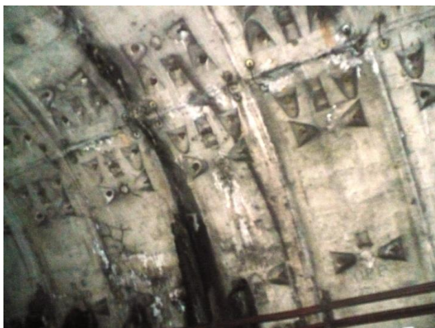
Infiltrații prin rost transversal, în boltă, la inel 875. Se etanșează cu rășină hidrostructurală cu vâscozitate redusă
