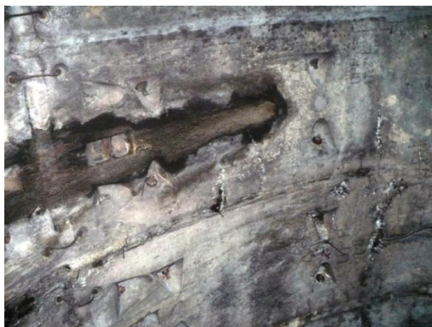
Infiltrație prin gaură de injectare primară, la inelul 722. Se etanșează prin injectare cu rășină poliuretanică
