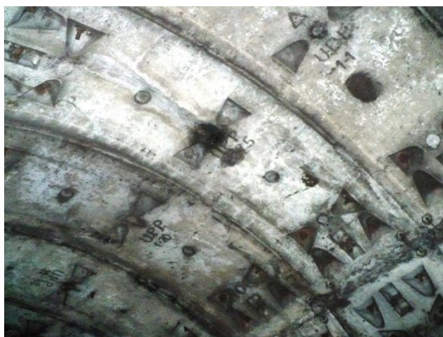
Picături prin gaură injectare primară, la bolțar din bolta inelului 205. Se etanșează cu rășină poliuretanică
