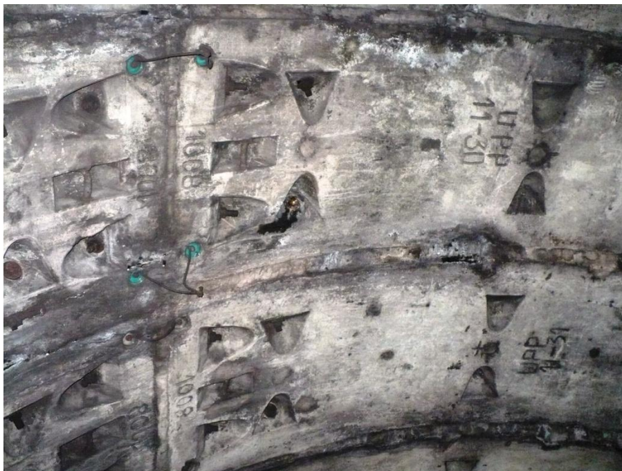
Infiltrații prin gaură de bulon, în bolta tunelului, la inel 15
