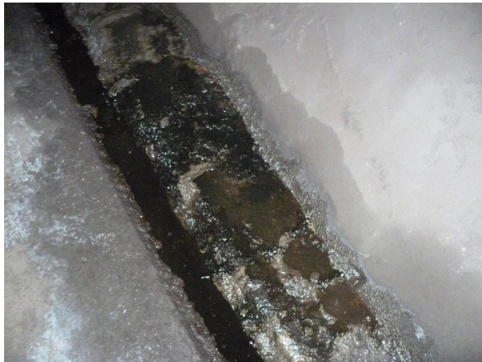
Infiltrații, la limita fundației de cale, în zona inelului 510
