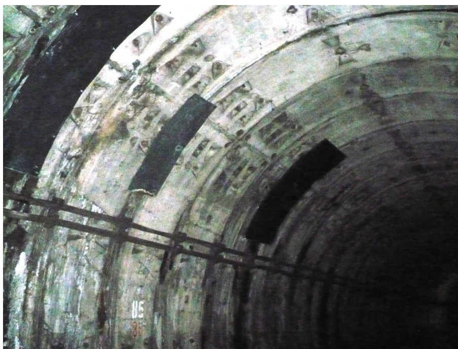
Infiltrații între rosturile bolțarilor din boltă, aoperite cu tablă (pentru protecția căii de rulare), în zona inelului 85
