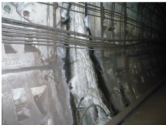
Infiltrații prin rosturile transversale dintre bolțari, lateral, la inelul 520. Se etanșează cu rășină hidrostructurală cu vâscozitate redusă
