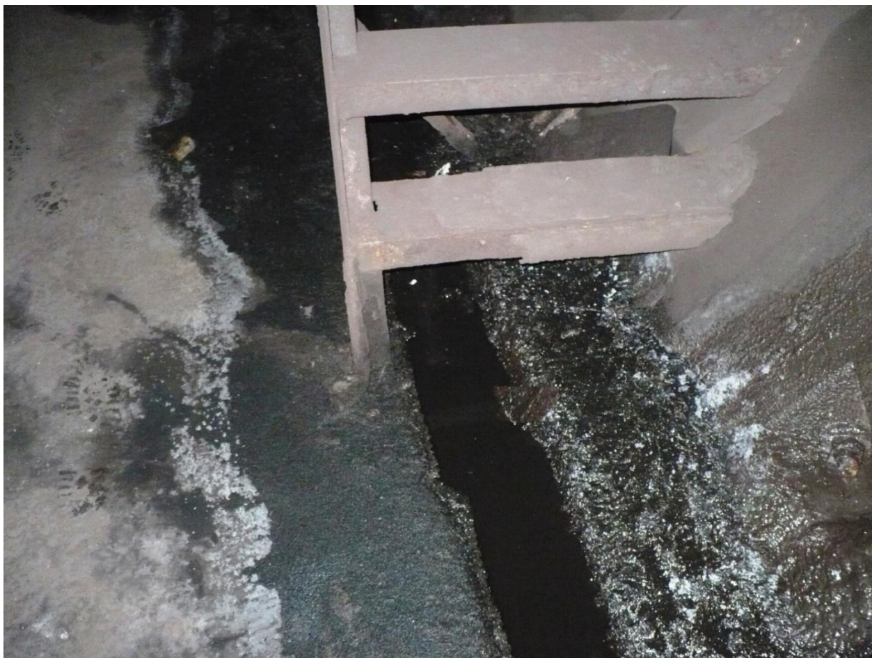
Infiltrații în zona fundației de cale, la inelul 675,
