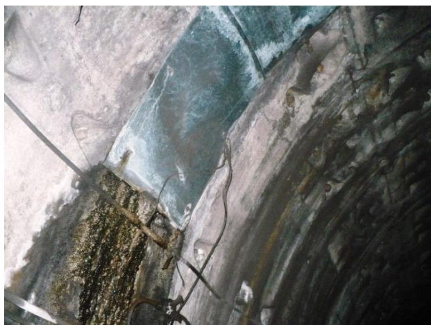
Infiltrație prin rost longitudinal între bolțari, la inel 75. Se etanșează prin injectare cu rășină hidrostructurală cu vâscozitate redusă
