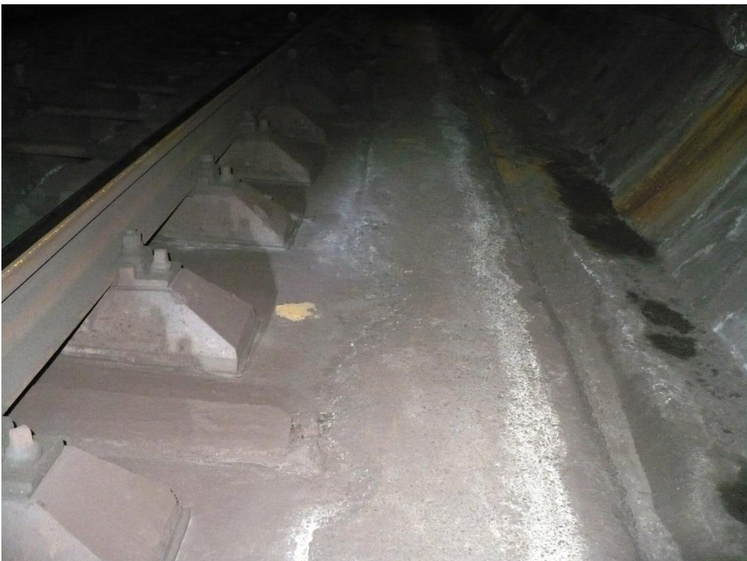
Porțiune de banchetă de circulație, din beton, turnată cu denivelări, între inelele 730 și 665
