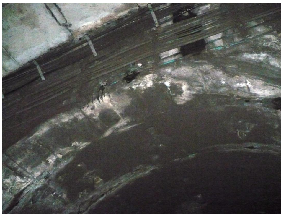
Infiltrație prin structura zonei de detentă a stației, în zona bolții tunelului. Se etanșează prin injectare cu rășină hidrostructurală cu vâscozitate redusă
