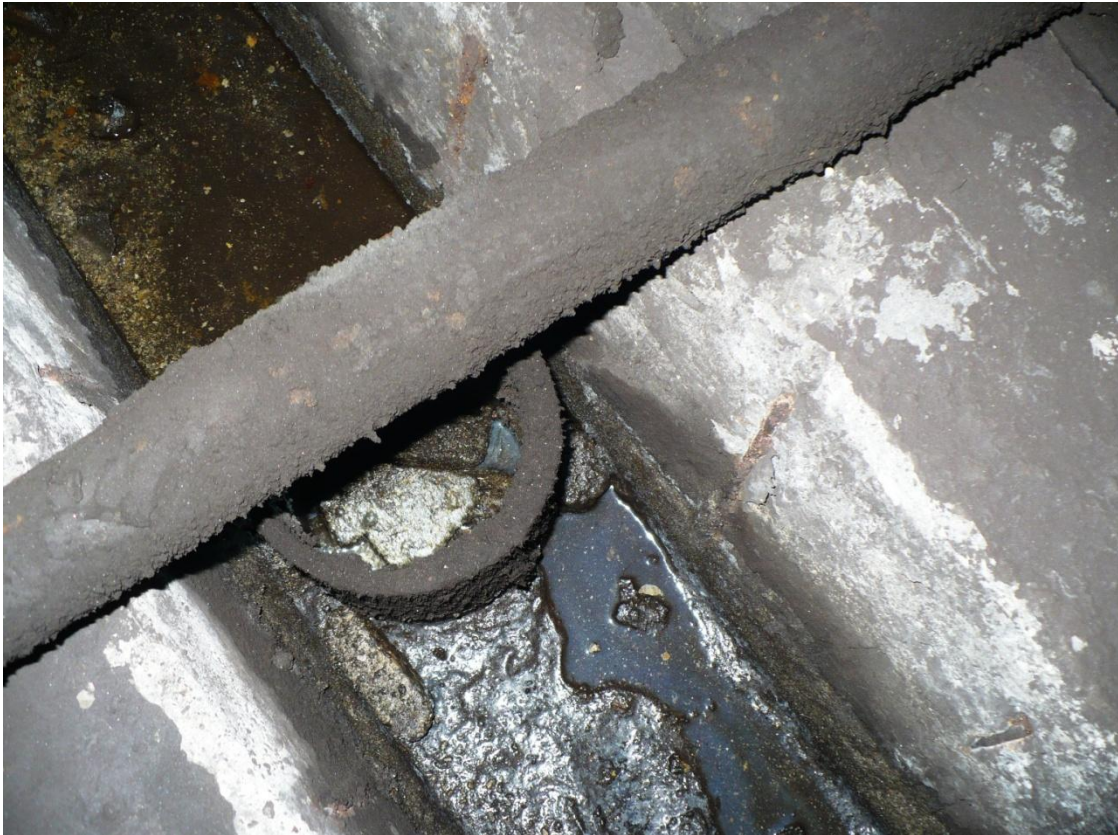
Țeava PVC Dn 150mm din dren, din dreptul inelului 660, este obturată (este colmatată, nefiind funcțională)
