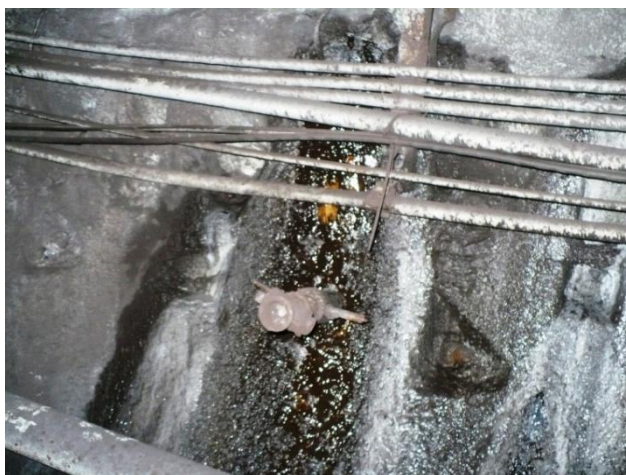
Infiltrație deasupra conductei de apă pentru incendiu, prin rost transversal, cu aport de nisip, la inelul 1490. Se etanșează cu rășină hidrostructurală cu vâscozitate redusă
