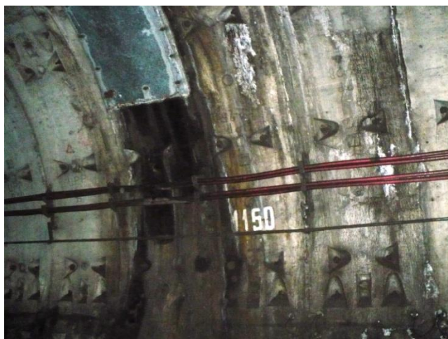
Infiltrații prin rosturile transversale dintre bolțari, în boltă, la inel 1150, acoperite cu tablă. Se etanșează cu rășină hidrostructurală cu vâscozitate redusă
