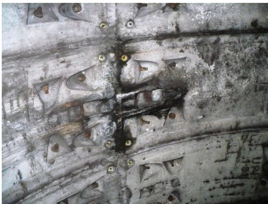
Infiltrații în zona bolții, la inelul 15, prin rost longitudinal între bolțari. Se etanșează cu rășină hidrostructurală cu vâscozitate redusă
