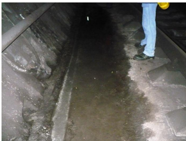
Infiltații prin fundația de cale, între inelele 680÷685. Este necesară demolarea fundației de cale (6m), etanșarea prin injectare cu rășină hidrostructurală cu vâscozitate redusă, urmat de refacerea acesteia
