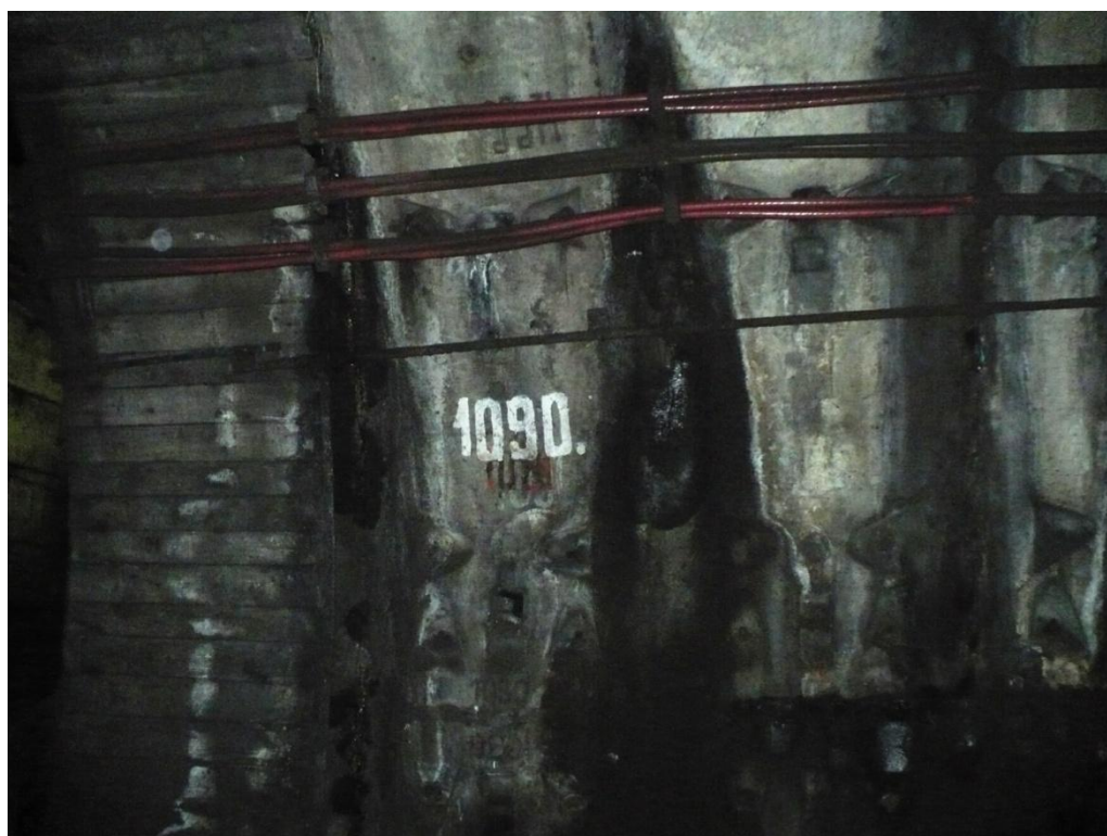
Infiltrații prin rosturi tansversale, lateral, în zona inelului 1090. Se etanșează cu rășină hidrostructurală cu vâscozitate redusă
