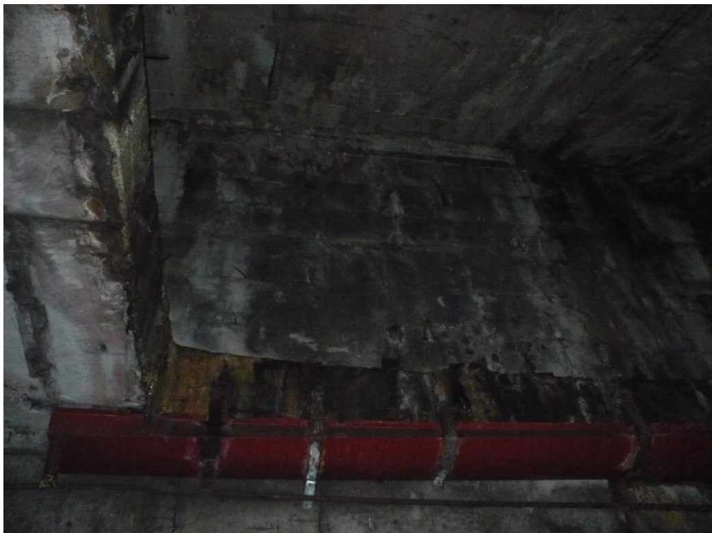
Infiltrații în bolta peretelui de fronton a inelului, la legătura cu stația Tineretului. Infiltrațiile trebuiesc oprite, acestea ajungând în zona căii de rulare.
