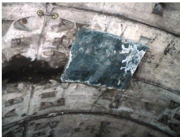
Infiltrații prin rost transversal, acoperit cu tablă, în boltă, la inel 595. Se etanșează cu rășină hidrostructurală cu vâscozitate redusă
