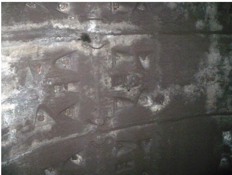
Infiltrație în bolta tunelului, la inel 5. Se etanșează prin injectare cu rășină poliuretanică
