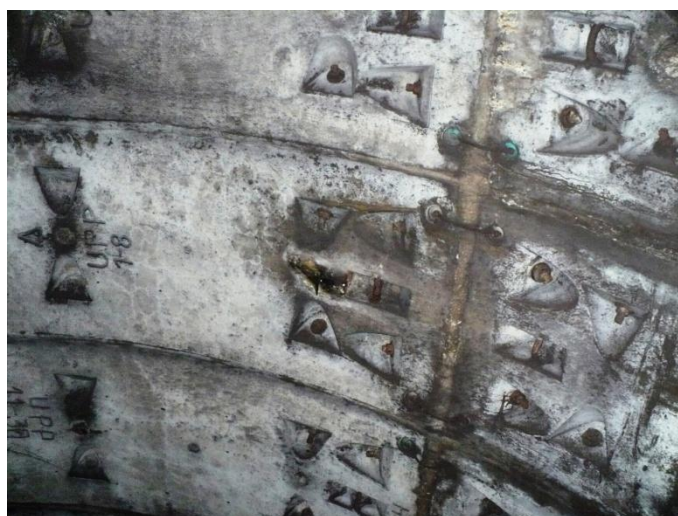
Infiltrație în bolta inelului 600
