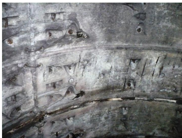
Infiltrație prin rost transversal între bolțari, la inel 560. Se etanșează prin injectare cu rășină hidrostructurală cu vâscozitate redusă
