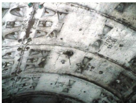
Picături prin gaură bulon la bolțar din bolta inelului 126. Se etanșează cu rășină poliuretanică
