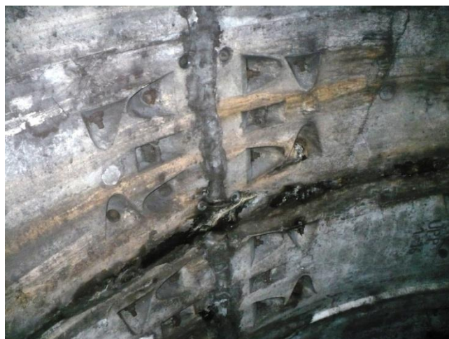
Infiltrații prin rosturile transversale, în boltă, la inel 1260. Se etanșează cu rășină hidrostructurală cu vâscozitate redusă
