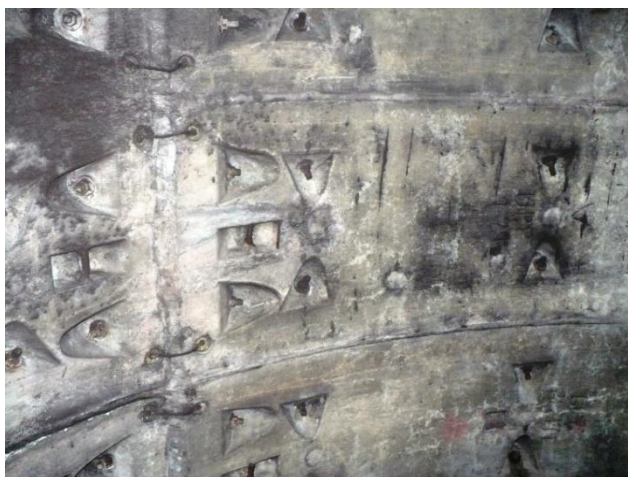
Infiltrație în bolta tunelului, la inel 550. Se etanșează prin injectare cu rășină poliuretanică
