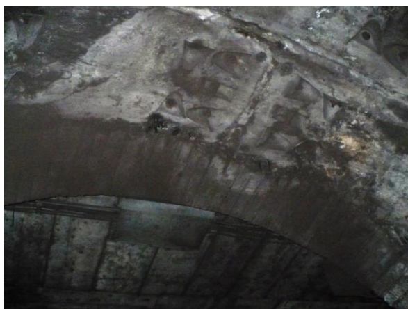
Infiltrații prin bolta peretelui de fronton. Se etanșează cu rășină poliuretanică
