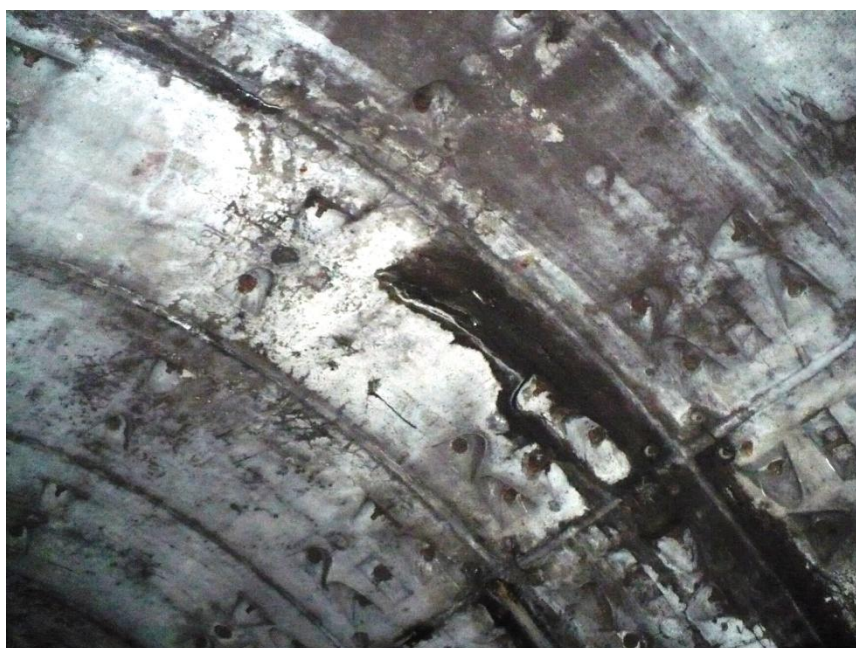
Infiltrație în bolta inelului 625, prin fisura existent în bolțar. Se etanșează zona cu rășină poliuretanică
