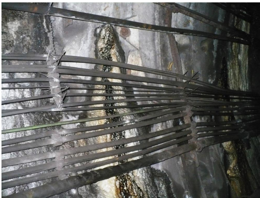
Infiltrații prin găurile de injectare din bolțarii laterali, la inelul 490. Este necesară etanșarea prin injectare cu rășină hidrostructurală cu vâscozitate redusă
