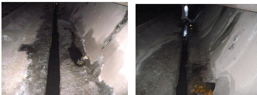
Infiltrații în zona fundației de cale, între 645÷660.
