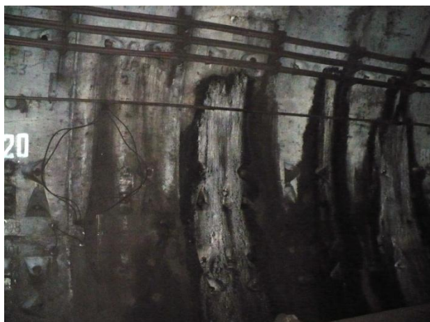
Infiltrații prin fisură în bolțar și găuri pentru buloane, în zona inelului 820. Se etanșează zona cu rășină poliuretanică
