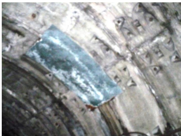
Infiltrație prin rost transversal între bolțari, la inel 509. Se etanșează prin injectare cu rășină hidrostructurală cu vâscozitate redusă
