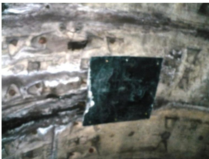
Infiltrații la rost transversal între bolțari, la inel 615, acoperit cu tablă. Se etanșează cu rășină hidrostructurală cu vâscozitate redusă
