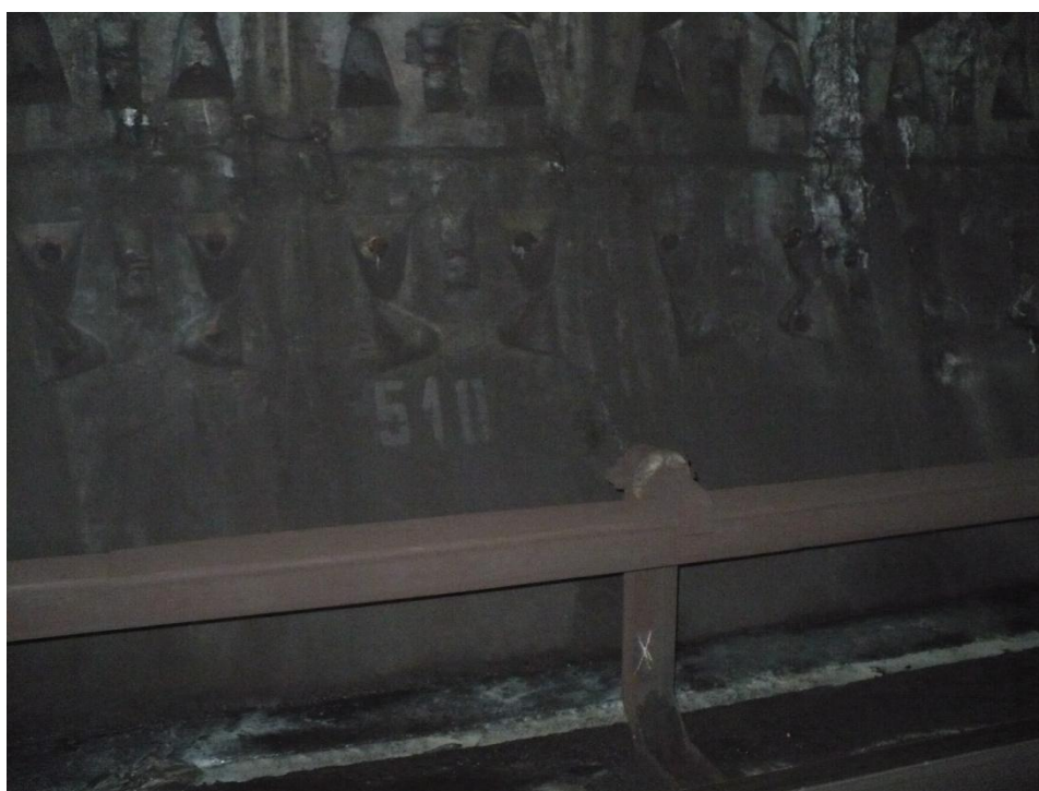
Infiltrație prin fundația căii de rulare, în zona inelului 510. Este necesară demolarea fundației de cale (4m), etanșarea prin injectare cu rășină hidrostructurală cu vâscozitate redusă, urmat de refacerea acesteia
