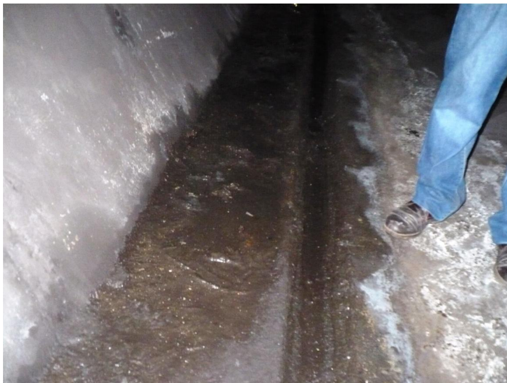
Infiltrații, lateral fundației de cale, între inelele 685÷660
