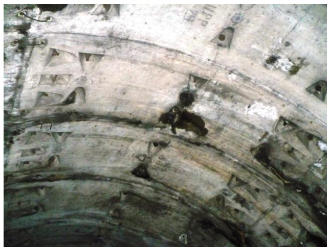
Infiltrații prin gaură injectare primară, în bolta inelului 1160. Se etanșează cu rășină poliuretanică
