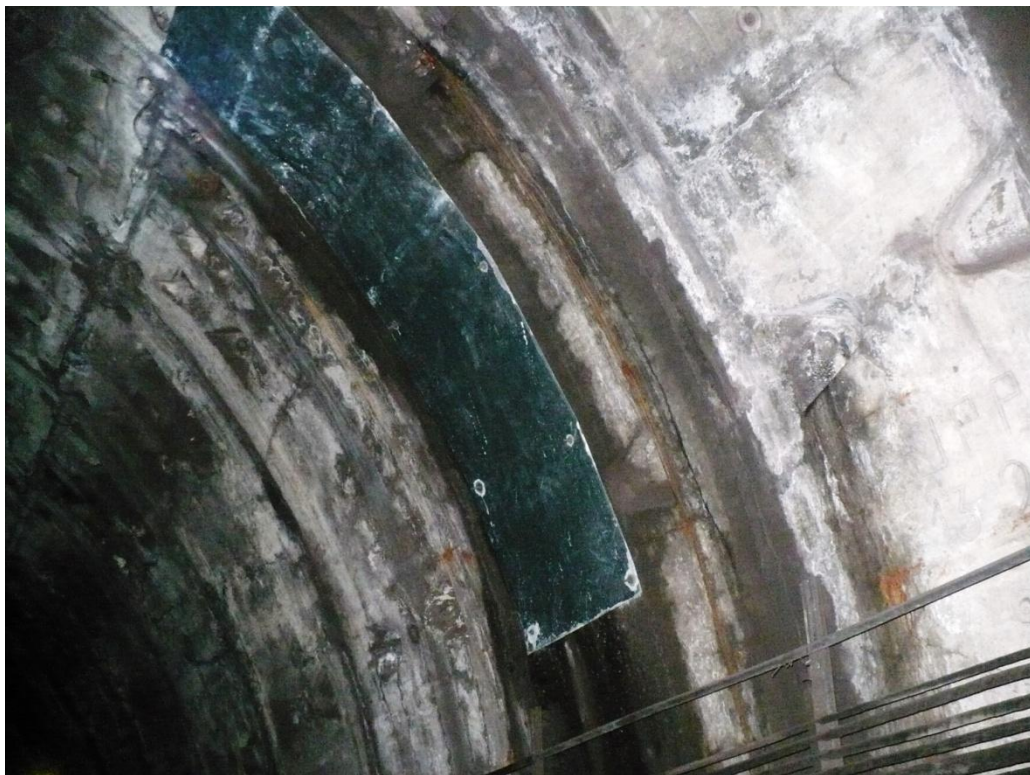
Zonă cu infiltrații în dreptul inelului 915, în zona bolții, acoperită cu tablă, pentru a împiedica ajungerea apei în zona de circulație a ramelor de metrou
