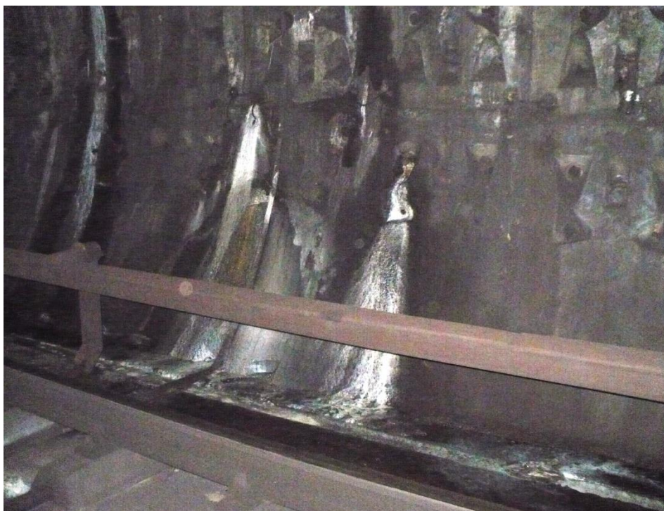
Situație identică și la inelele 519 și 518. Se etanșează cu rășină poliuretanică
