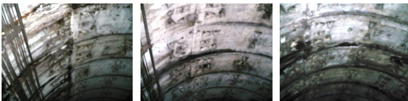
Infiltrații prin rost transversal în bolta inelelor 455, 490 și 620. Se etanșează cu rășină hidrostructurală cu vâscozitate redusă
