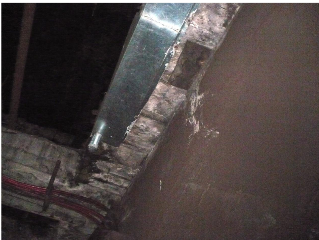
Infiltrații din zona pereților murați, la partea superioară, dirijate prin jgheab din tablă și descărcare în lateral
