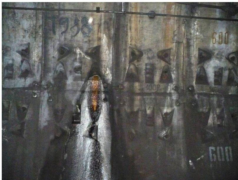
Infiltrație cu aport de nisip, la rostul longitudinal dintre bolțarii inelului 602. Este necesară etanșarea prin injectare cu rășină hidrostructurală cu vâscozitate redusă
