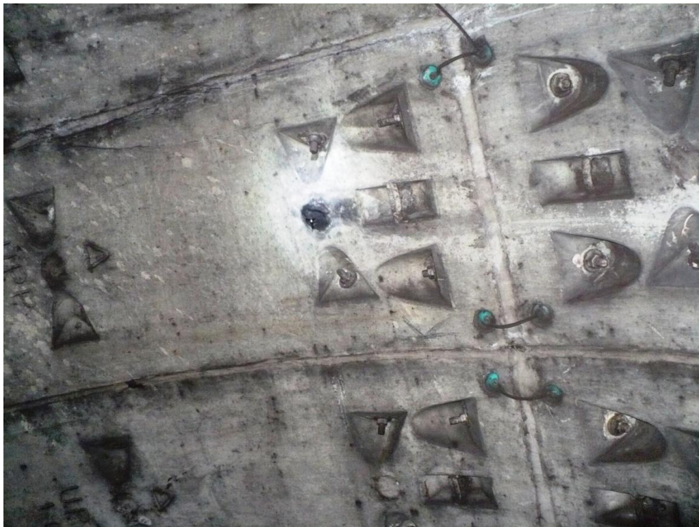
Infiltrație prin gaură injecție primară, în bolta inelului 310
