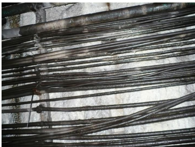
Infiltrații prin rosturile dintre boltari, cu aport de material solid, la inelele 450 și 455. Se etanșează prin injectare cu rășină hidrostructurală cu vâscozitate redusă
