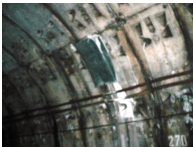
Infiltrații prin rost transversal în bolta inelului 270, acoperit cu tablă. Se etanșează cu rășină hidrostructurală cu vâscozitate redusă
