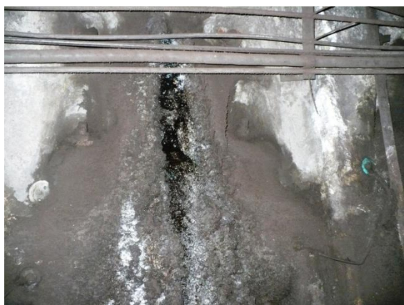
Infiltrații prin rost transversal, între bolțarii inelului 10. Se etanșează cu rășină hidrostructurală cu vâscozitate redusă
