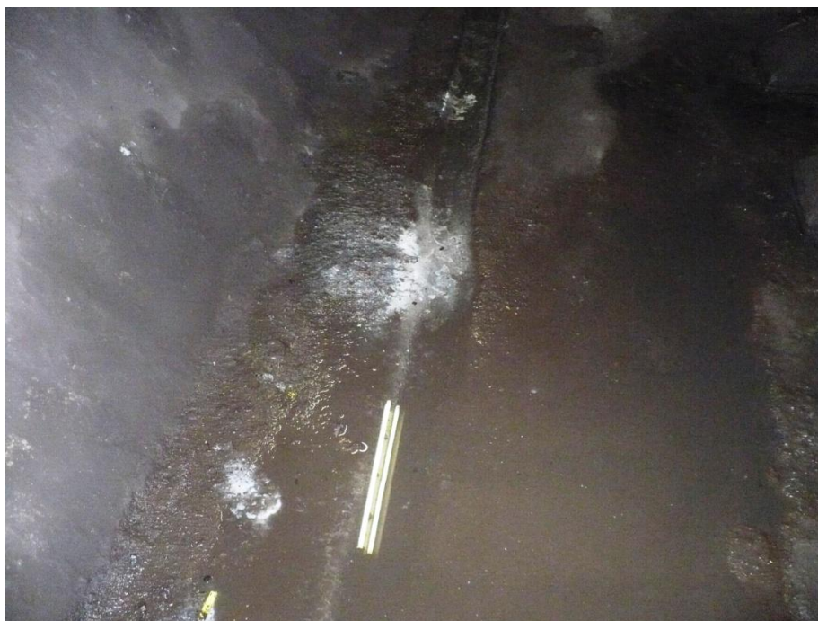
Infiltrație prin fundația căii de rulare, în zona inelului 870. Este necesară demolarea fundației de cale (3m), etanșarea prin injectare cu rășină hidrostructurală cu vâscozitate redusă, urmat de refacerea acesteia
