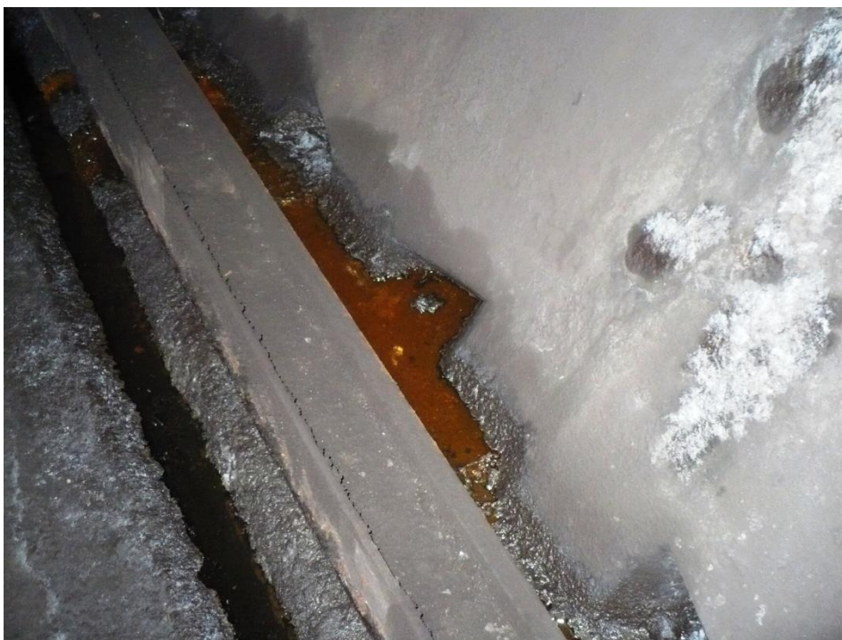
Infiltrații, cu aport de nisip, în zona inelului 525
