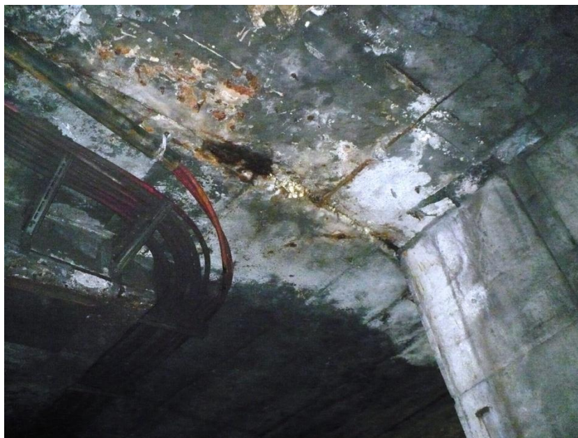
Infiltrații prin rostul total al planșului.
