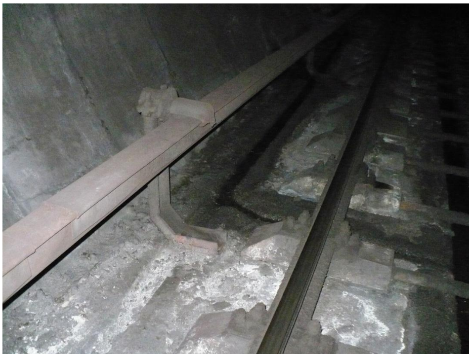
Infiltrații între fundația de cale și inelul 230
