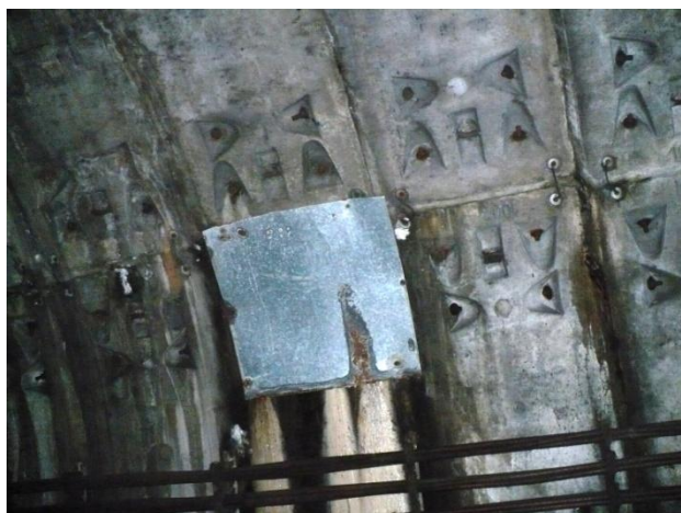
Infiltrație prin gaură de injectare primară, acoperită cu tablă, la inelul 635. Se etanșează prin injectare cu rășină poliuretanică
