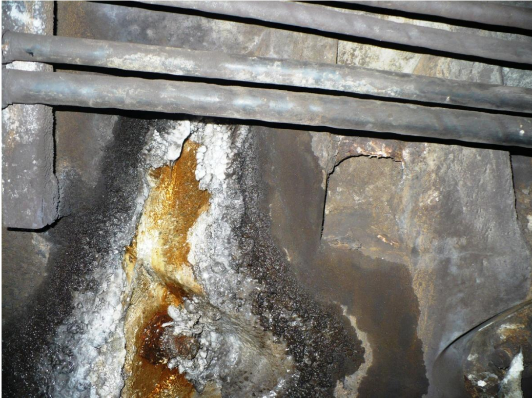
Infiltrație cu aport de nisip, prin gaură bulon, la inel 340
