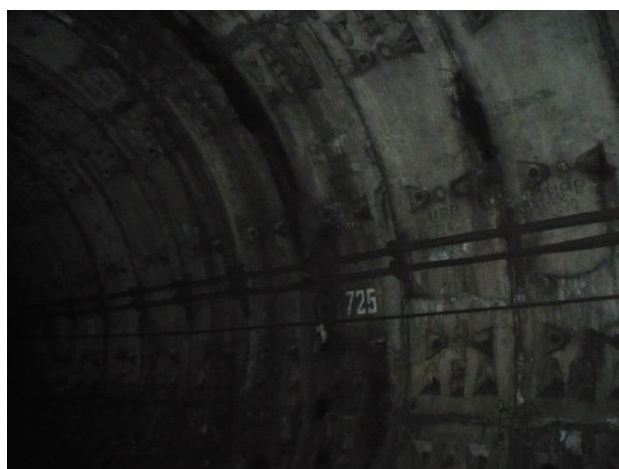
Infiltrații prin rost transversal, în zona bolții, la inel 725. Se etanșează cu rășină hidrostructurală cu vâscozitate redusă
