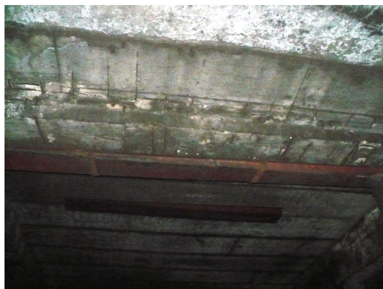
Infiltrații prin zona de acoperiș a PLS-ului, acoperite cu tablă prevăzute cu scurgeri laterale căii de rulare
