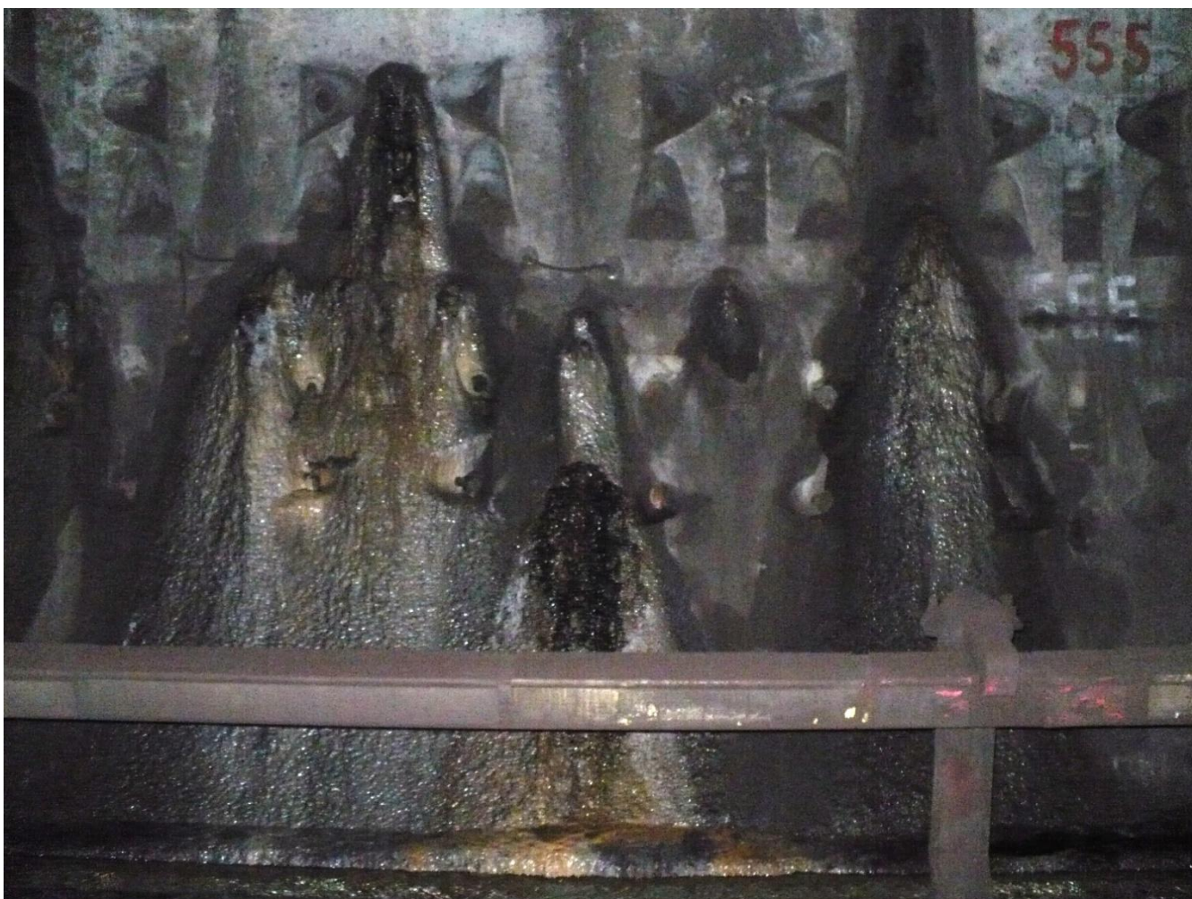
Infiltrații prin rosturile bolțarilor și prin găurile de injectare, cu aport de nisip, la inelul 555
