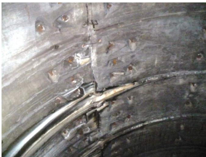
Infiltrații prin rostul transversal dintre bolțari, în bolta tunelului, la inelul 1680. Se etanșează cu rășină hidrostructurală cu vâscozitate redusă
