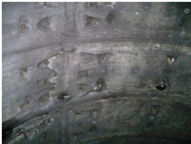
Infiltrații prin gaură bulon, în bolta tunelului, la inel 1455. Se etanșează cu rășină poliuretanică
