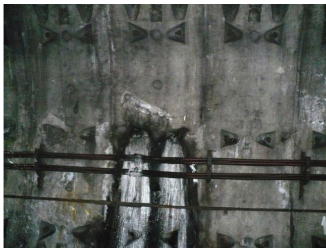
Infiltrații prin găuri buloane, la inel 1420. Se etanșează cu rășină poliuretanică
