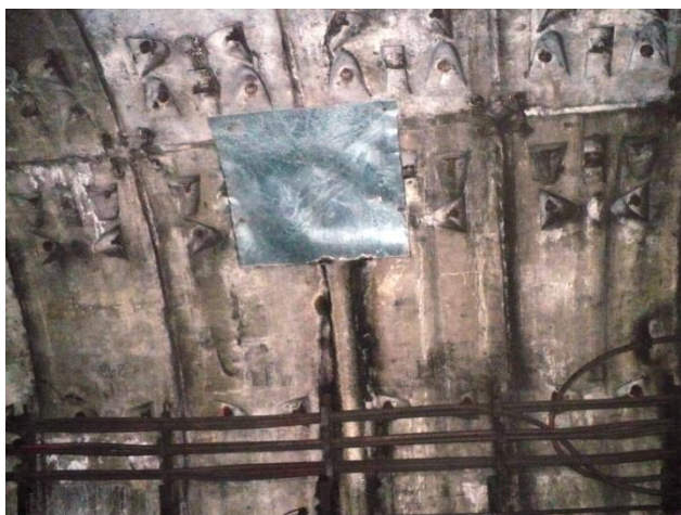
Infiltrație prin rost transversal între bolțari, la inelul 685. Se etanșează prin injectare cu rășină hidrostructurală cu vâscozitate redusă
