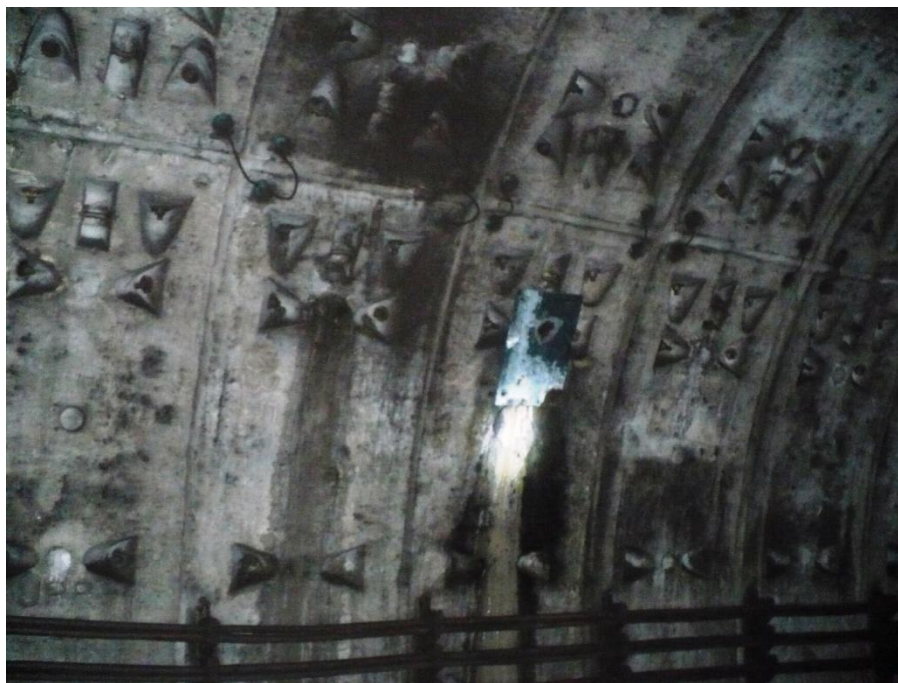
Infiltrație, cu presiune, prin gaura de injectare suspensii de ciment -bentonită, acoperită cu tablă, la inelul 1335
